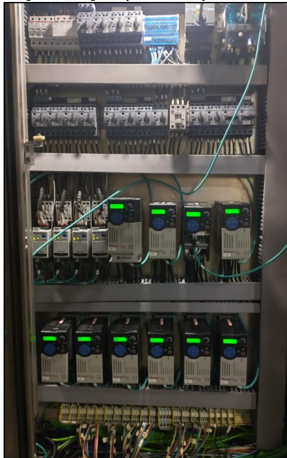
Figura 32 - Segunda parte do novo painel elétrico.
