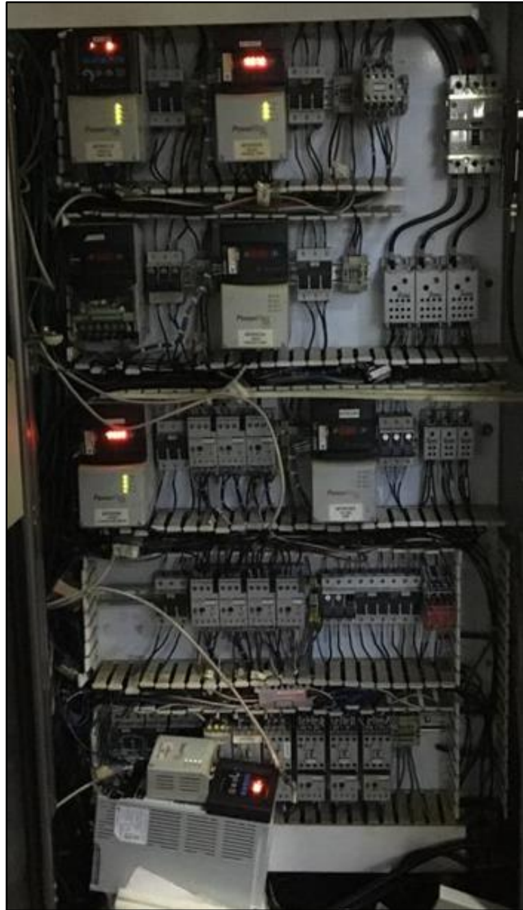
Figura 19 - Segunda parte do painel elétrico da máquina de pulverização de óleo.
