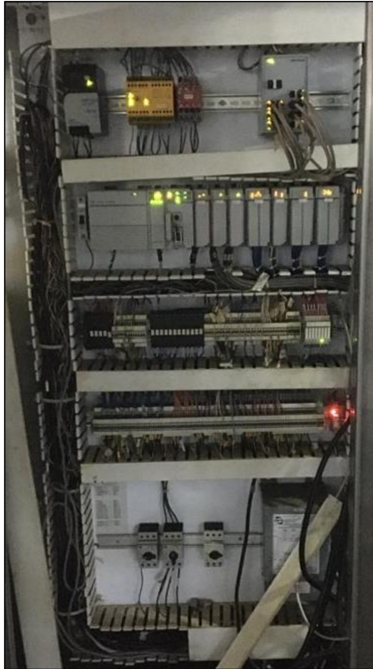
Figura 18 - Primeira parte do painel elétrico da máquina de pulverização de óleo.
