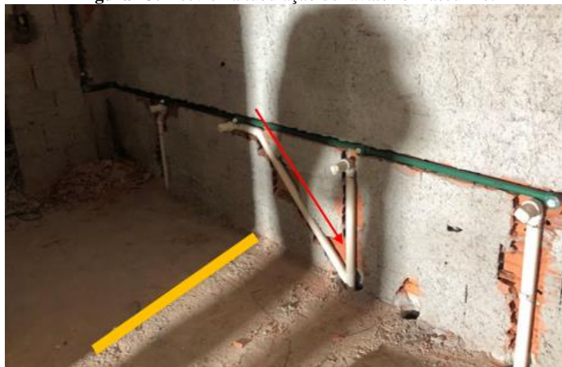
Figura 13: Desvio na tubulação do lavatório masculino.
