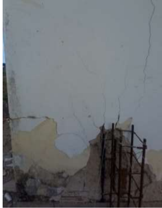
Figura 20 - Manifestações patológicas no exterior da sala de aula 13 (Imagem 2)
