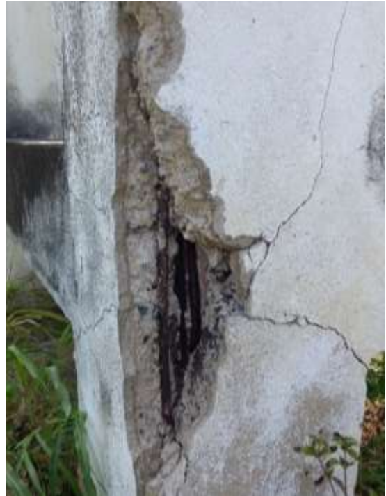
Figura 14 - Manifestações patológicas no reservatório elevado (mais próximo)
