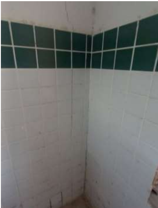
Figura 17 – Manifestações patológicas no interior da sala de aula 13 (Imagem 1)
