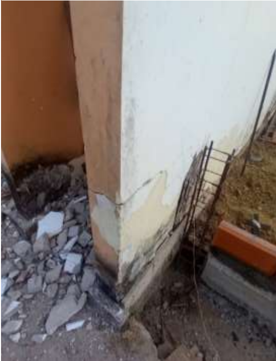
Figura 19 - Manifestações patológicas no exterior da sala de aula 13 (Imagem 1)
