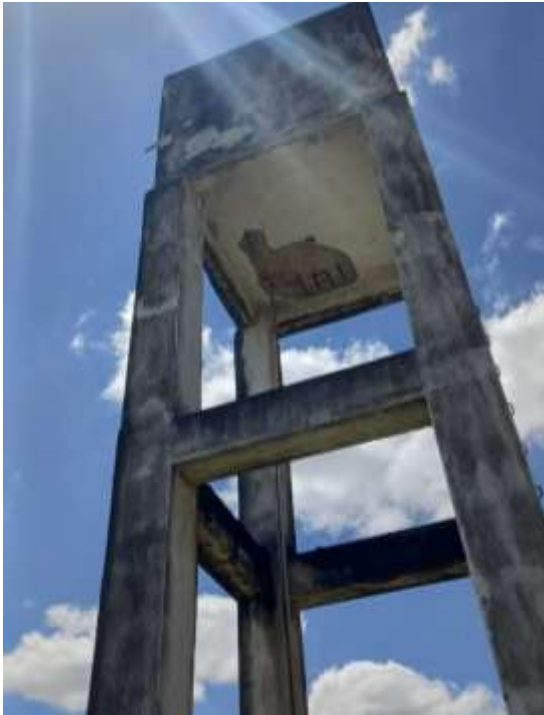
Figura 13 - Manifestações patológicas no reservatório elevado
