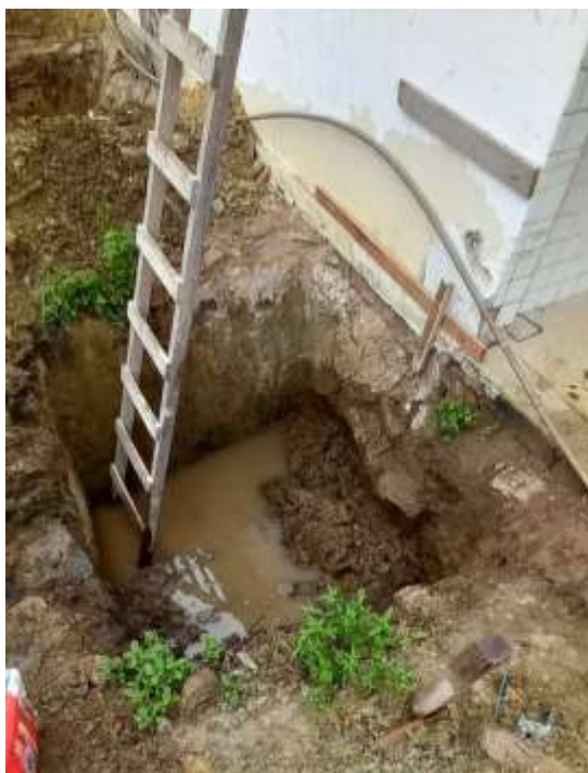
Figura 22 – Recalque do solo em volta da sapata existente - Biblioteca
