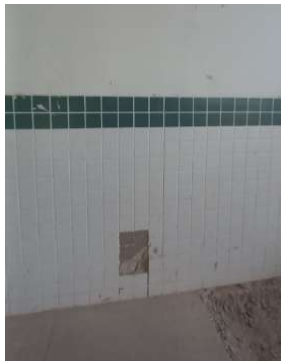
Figura 18 - Manifestações patológicas no interior da sala de aula 13 (Imagem 2)
