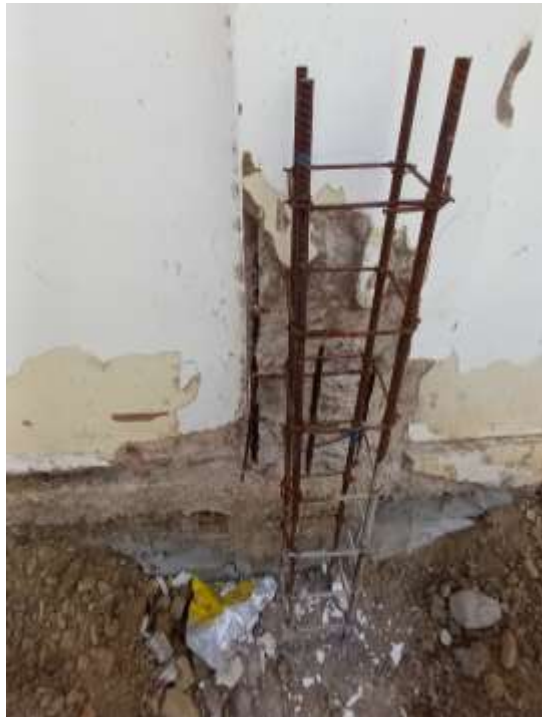
Figura 21 - Manifestações patológicas no exterior da sala de aula 13 (Imagem 3)
