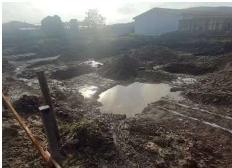
Figura 35 - Acúmulo de água nas valas após chuva
