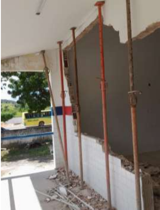
Figura 9 - Necessidade de escoras 1 - Secretaria
