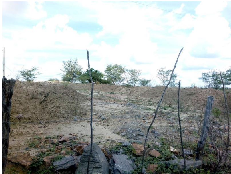
Imagem 3: Descarte de aterro nas proximidades do paredão da barragem.
