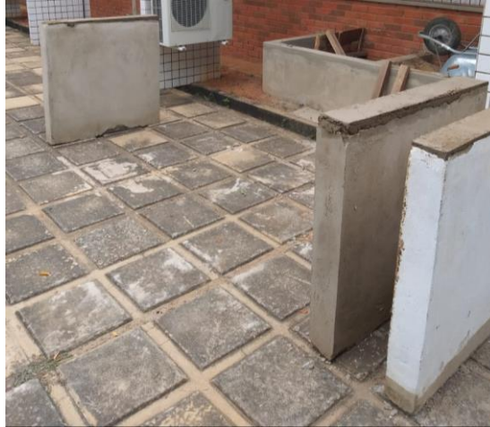
Figura 13: Nivelamento pronto da parte superior das paredes de alvenaria que vai receber a laje
