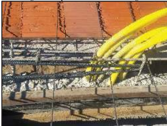
Figura 27 - Passagem inadequada de eletrodutos em viga a ser concretada
