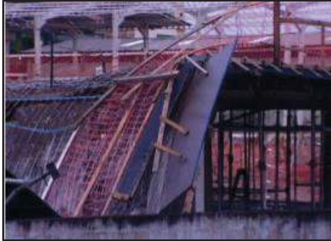
Figura 9 - Desabamento de laje por escoramento insuficiente
