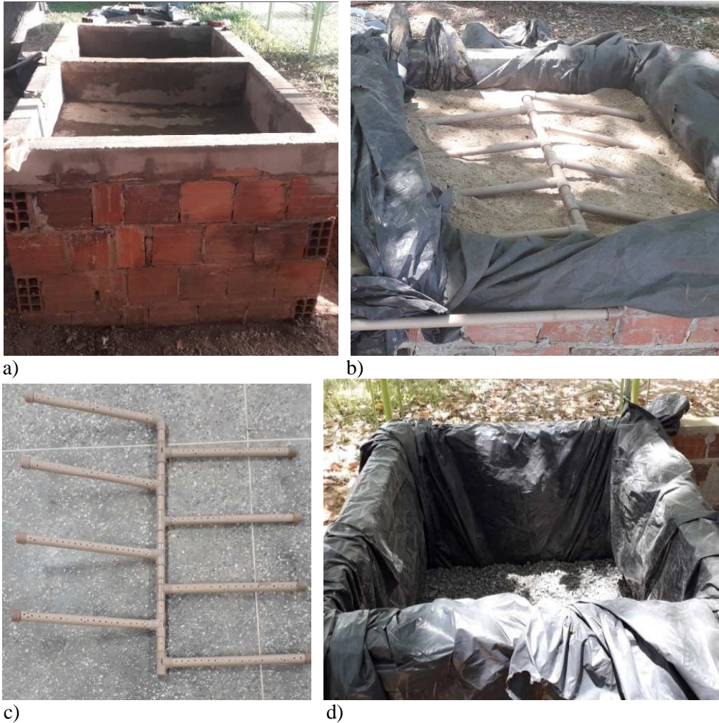
Figura 5: a)Execução da alvenaria na ZR; b)Preenchimento da camada de areia nos FT antes de cobrir a tubulação de entrada; c)Tubulação Ø25mm em formato de espinha de peixe; d)Preenchimento da camada de brita nos FT.
