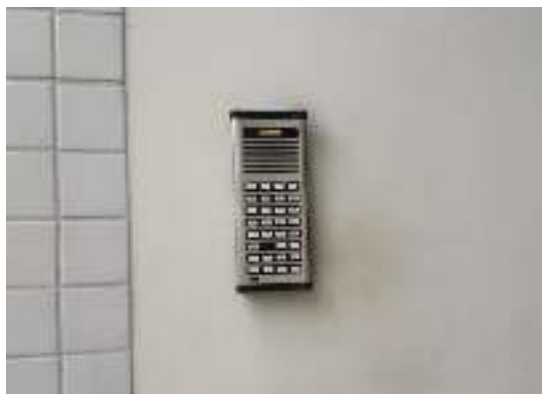
Figura 13: Interfone da edificação
