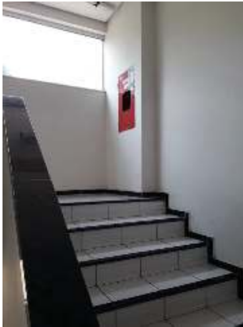
Figura 16: Localização do hidrante em um dos pavimentos da edificação
