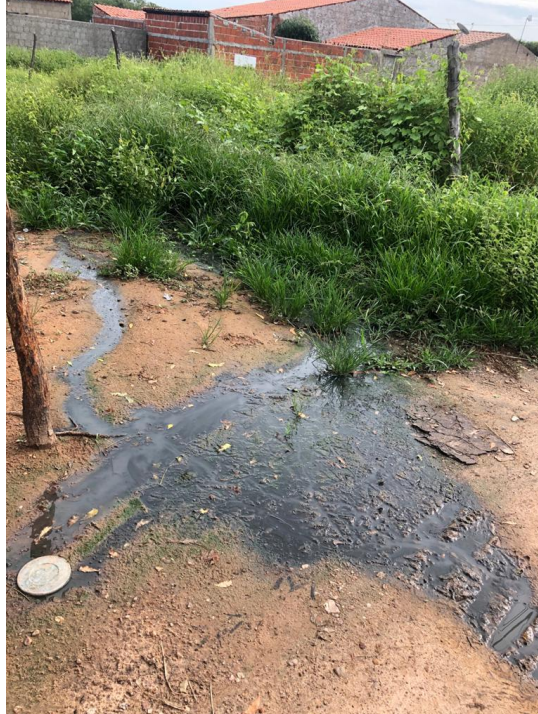
Figura 3 – Esgoto a céu aberto numa das ruas do bairro analisado.
