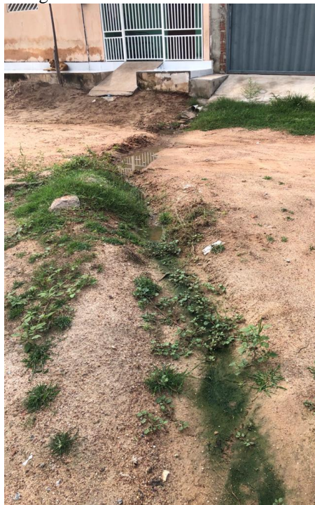
Figura 2 – Saída de esgoto de residência situada no Bairro Francisco Liberato.
