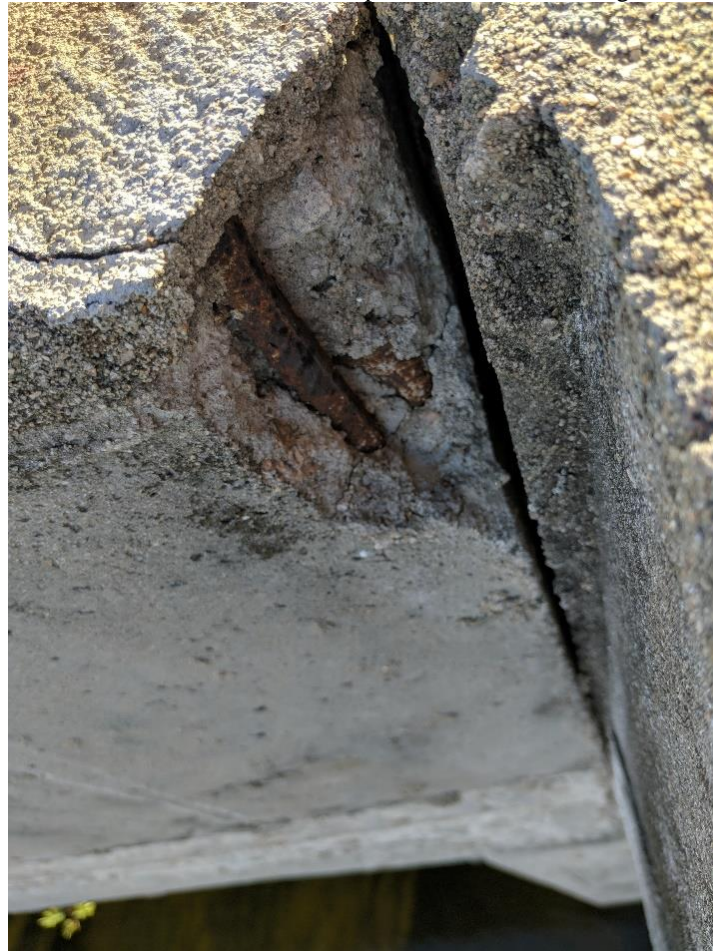
Figura 20 - Corrosão de armadura na parte lateral externa do guarda-corpo.
