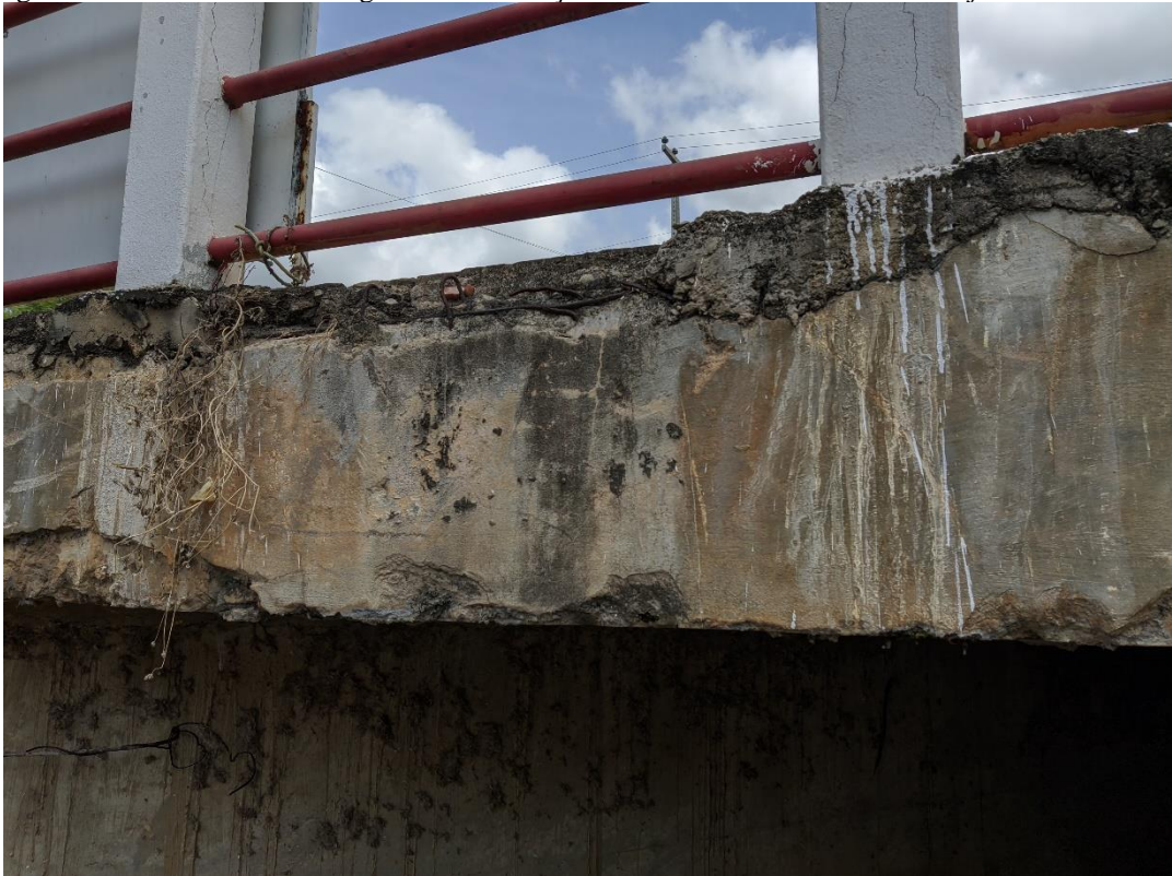
Figura 29 - Destacamento da argamassa em relação ao concreto na face lateral da laje da Estrutura III.
