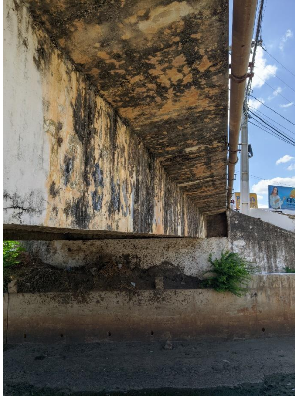
Figura 34 - Manchas e fissuras na face lateral externa da longarina e face inferior da laje de passeio.
