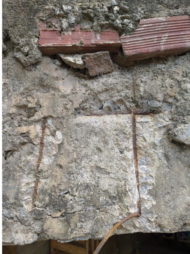
Figura 28 - Corrosão de armadura na face lateral da laje da Estrutura III.
