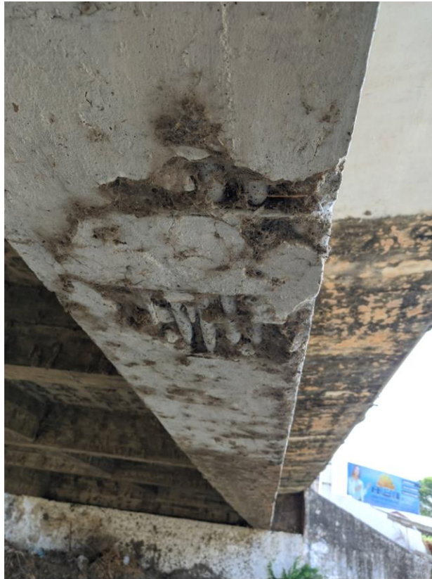
Figura 32 – Armaduras longitudinais da longarina expostas e corroídas.
