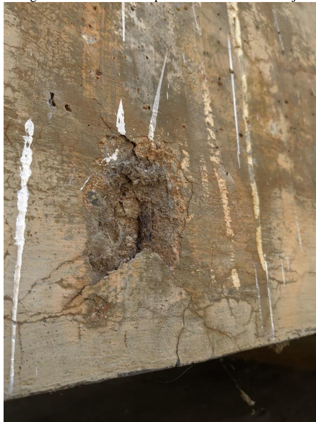
Figura 25 - Armadura exposta na face lateral da laje.
