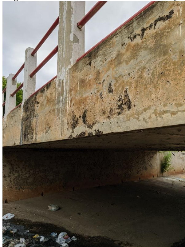
Figura 23 - Fissuras e manchas na face lateral da laje.
