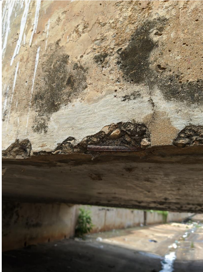
Figura 27 - Corrosão de armadura na face lateral da laje da Estrutura III.
