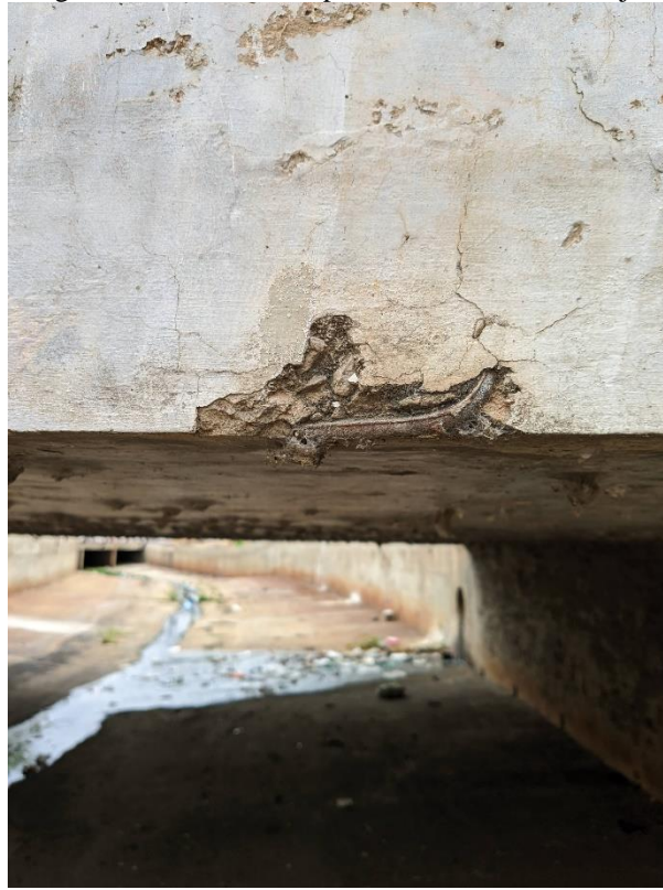
Figura 24 - Armadura exposta na face lateral da laje.
