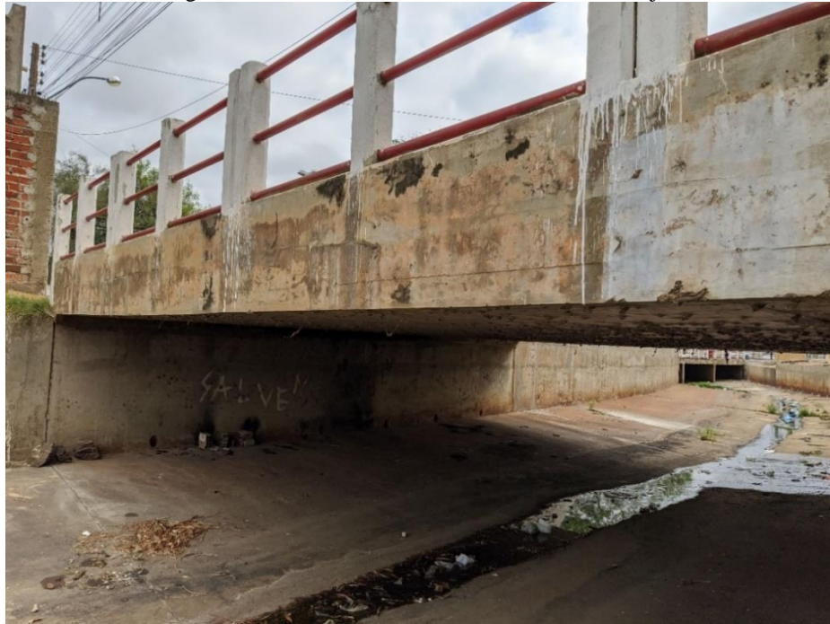
Figura 22 - Manchas e fissuras na face lateral da laje.
