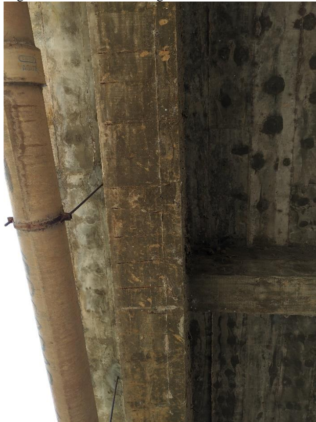
Figura 33 - Estribos das longarinas evidentes e corroídos.
