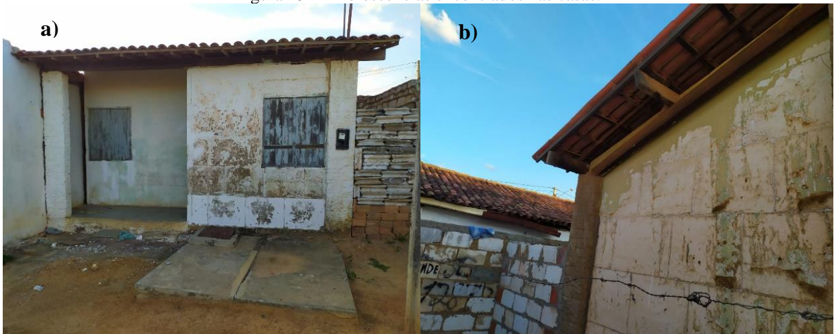
Figura 25 – Eflorescências encontrados nas casas.
