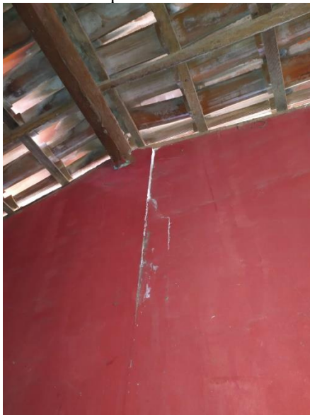
Figura 30 – Fissura presente na cumeeira do telhado.
