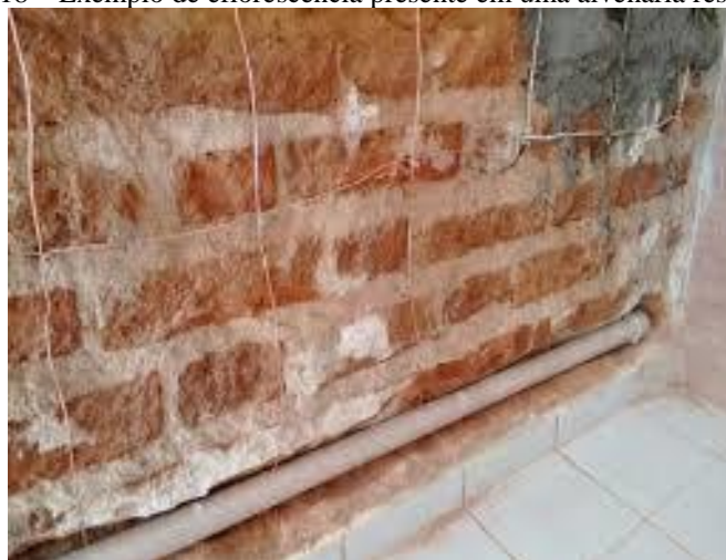
Figura 18 – Exemplo de eflorescência presente em uma alvenaria residencial.
