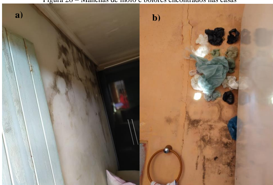
Figura 26 – Manchas de mofo e bolores encontrados nas casas
