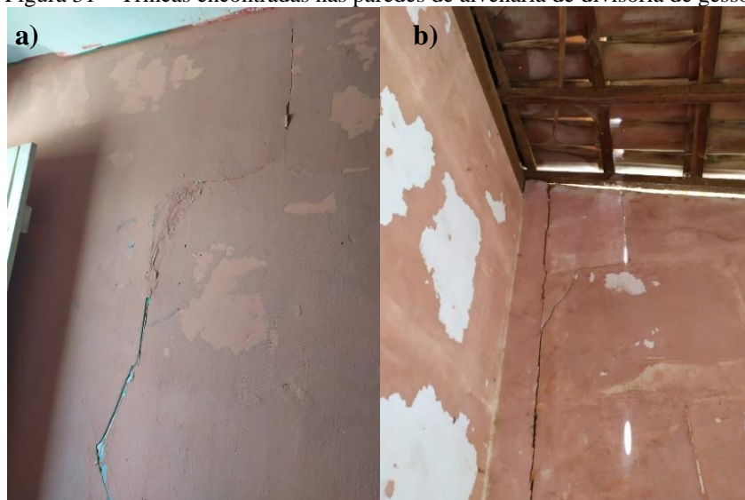
Figura 31 – Trincas encontradas nas paredes de alvenaria de divisória de gesso.
