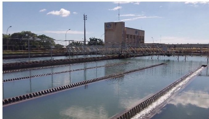
Figura 16 - Decantador de fluxo horizontal em funcionamento
