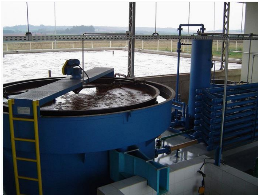
Figura 21 - Tanque de flotação
