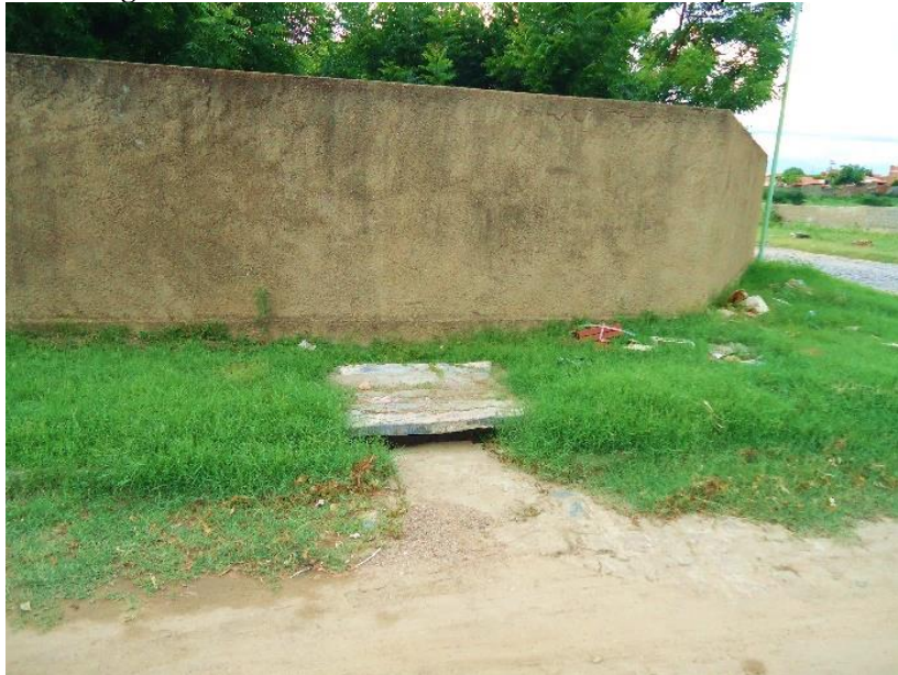
Figura 4 – Boca de lobo localizada em via sem calçamento
