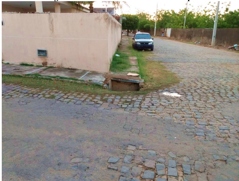
Figura 5 – Caixa da boca de lobo sem tampa
