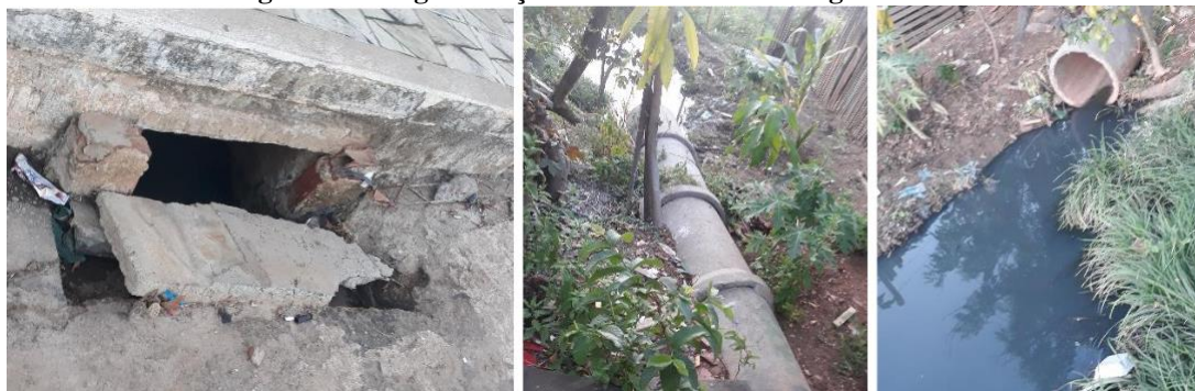
Figura 12 – Esgoto lançado no sistema de drenagem urbana
