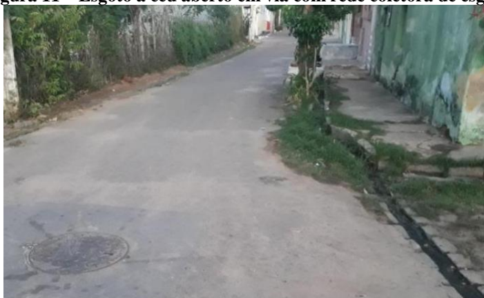
Figura 11 – Esgoto a céu aberto em via com rede coletora de esgoto
