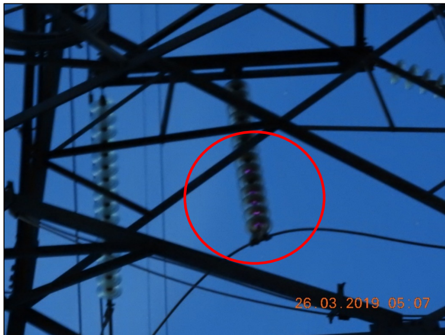
Foto 1 - Formação do efeito corona entre discos isoladores Fonte: Contribuição Taesa
