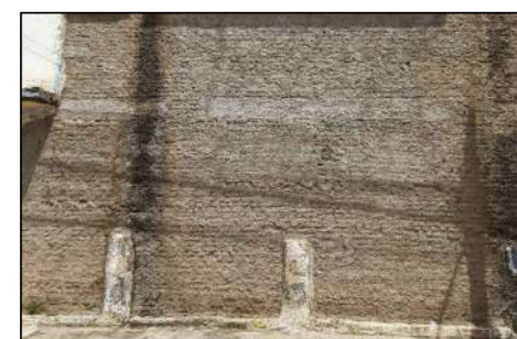
DESCOLAMENTO DE REVESTIMENTO NA FACHADA LESTE
