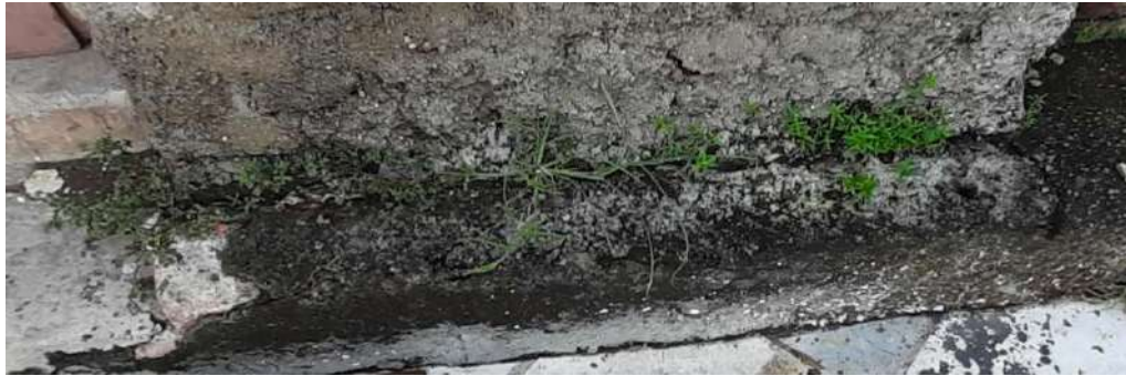
Figura 21 – Vegetação crescendo na base da edificação.
