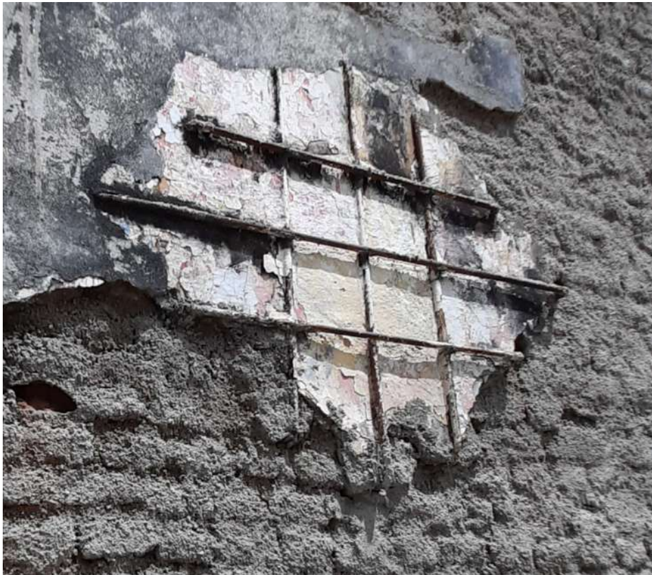
Figura 16 – Corrosão de elemento metálico.
