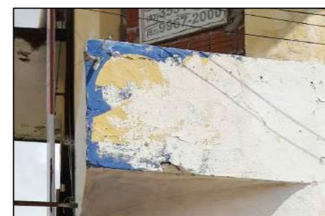
EMBOLOMENTO E DESCASCAMENTO DE PINTURA NA SACADA
