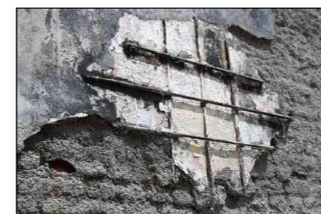
CORROSÃO EM ELEMENTO DE METAL NA FACHADA LESTE
