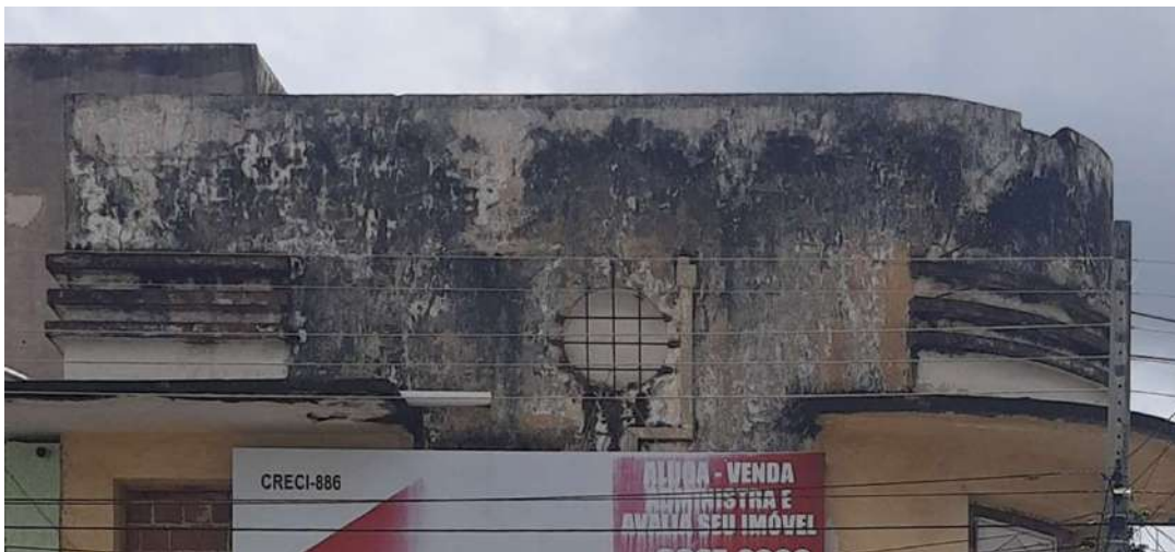
Figura 15 – Sujidades na fachada da edificação.
