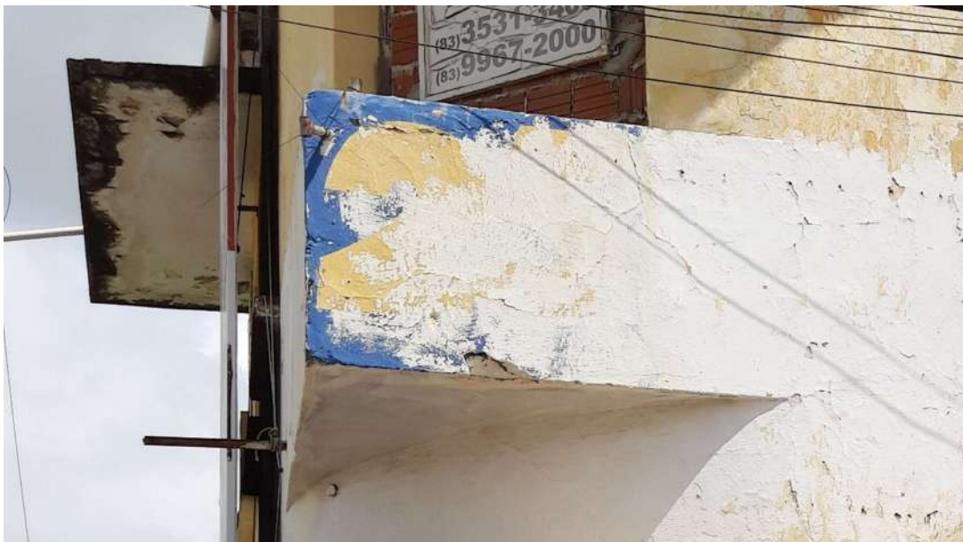
Figura 14 – Empolamento e descascamento da pintura.
