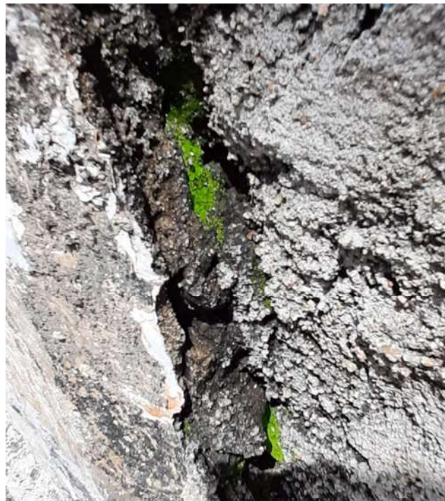
Figura 22 – Fungo se desenvolvendo em ponto da fachada leste da edificação.
