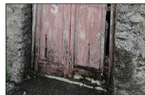
DETERIORAÇÃO DE MADEIRA EM PORTA DA FACHADA SUL
