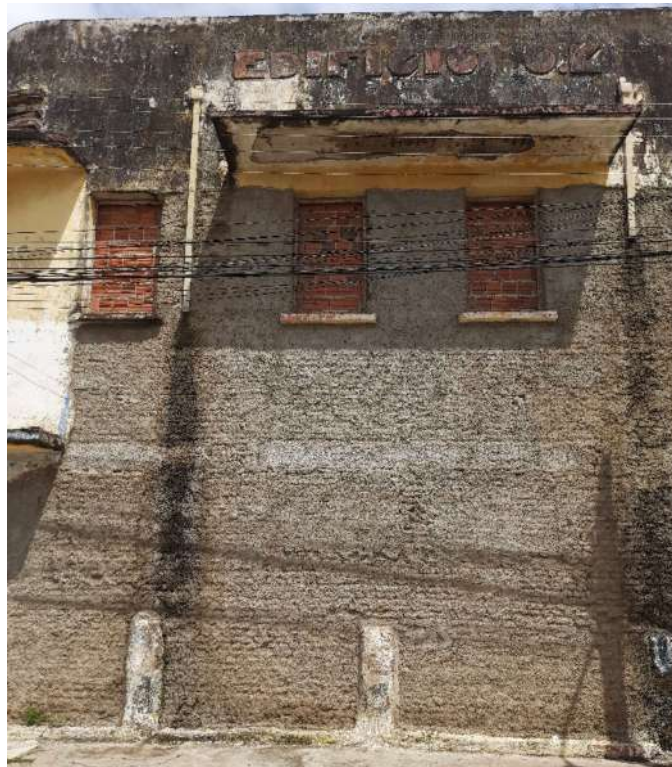
Figura 13 – Descolamento de revestimento.
