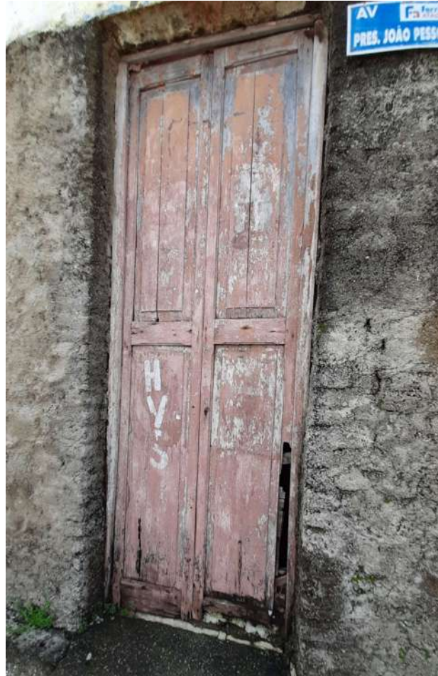
Figura 17 – Porta do pavimento térreo em estado de deterioração.
