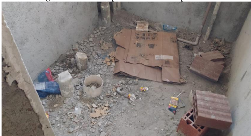
Figura 6: Resíduos espalhados no terceiro pavimento.
