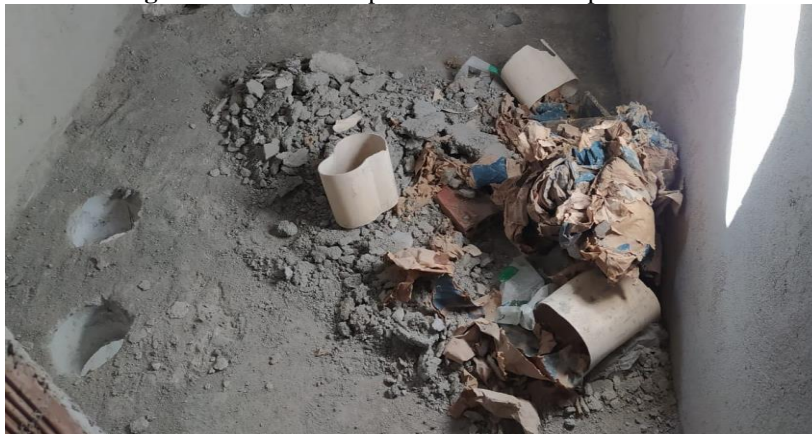
Figura 7: Resíduos empilhados no terceiro pavimento.
