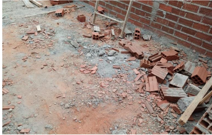
Figura 16: Resíduos espalhados ao longo do canteiro de obra.
