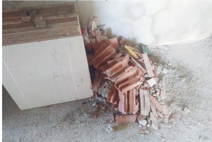
Figura 13: Resíduos empilhados próximo ao revestimento cerâmico.
