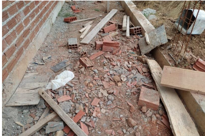
Figura 17: Resíduos espalhados localizados na lateral da construção.
