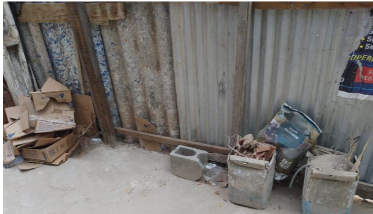
Figura 38: Resíduos acumulados em latas de tintas na entrada do canteiro de obra.
