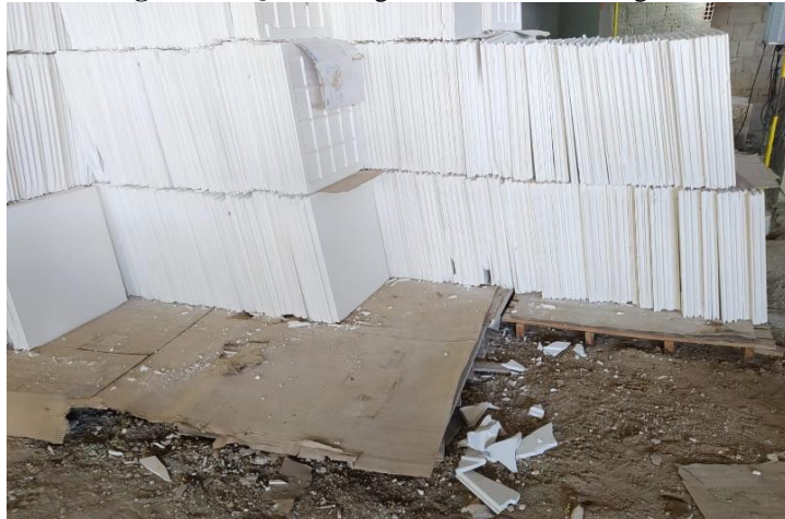
Figura 19: Quebra do gesso durante a estocagem.
