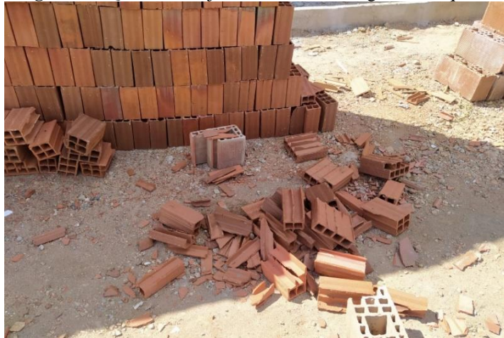
Figura 18: Quebra dos tijolos devido a estocagem inadequada.
