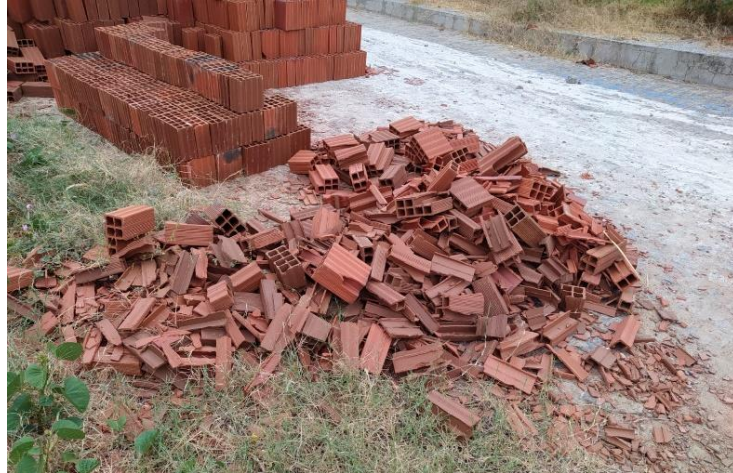
Figura 21: Tijolos quebrados estocados na lateral do canteiro de obra.
