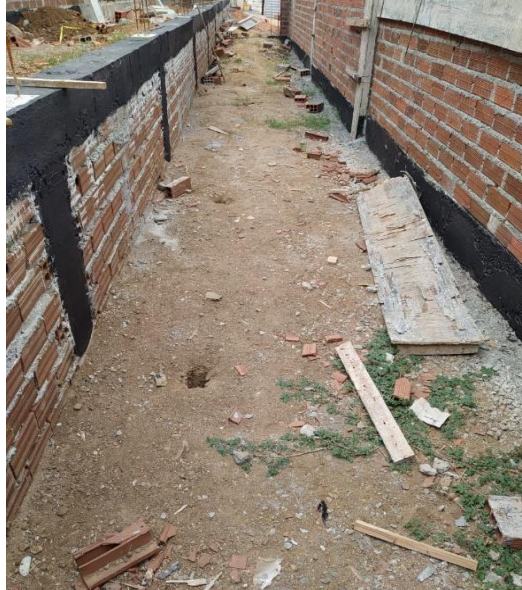
Figura 41: Resíduos espalhados no canteiro de obra.
