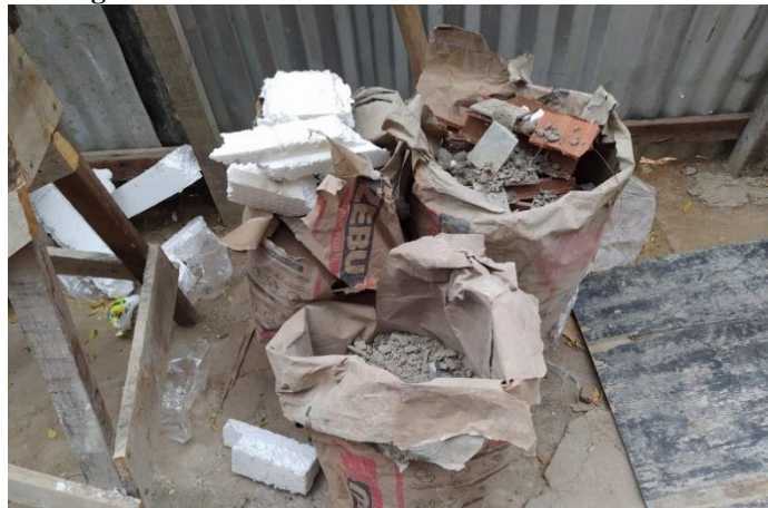
Figura 39: Resíduos acumulados em sacos de cimento.
