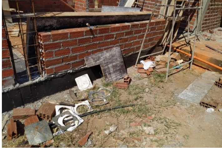
Figura 30: Resíduos espalhados e misturados ao longo da obra D.
