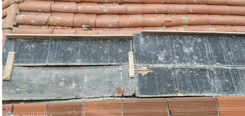
Figura 49: Restos de madeira usados para proteger as telhas da casa vizinha.
