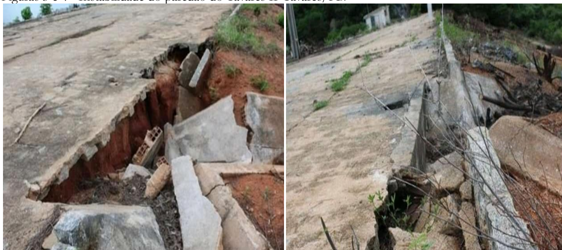
Figuras 3 e 4 - Instabilidade do paredão do Tavares II-Tavares/PB.
