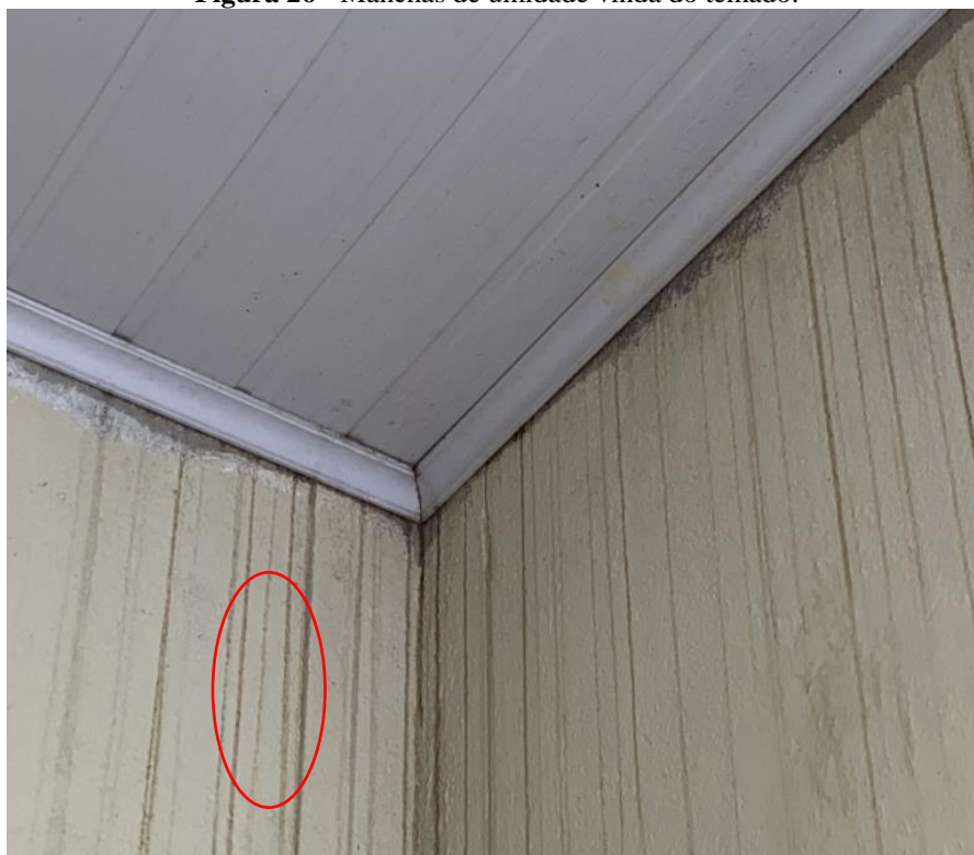
Figura 26 - Manchas de umidade vinda do telhado.
