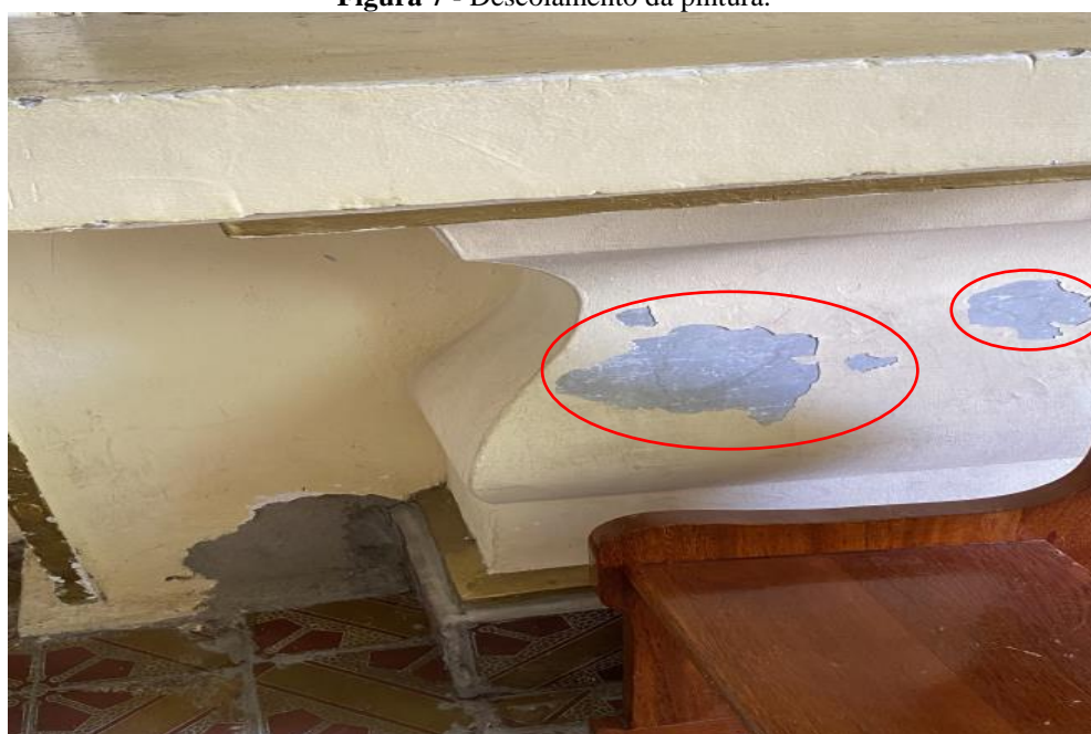
Figura 7 - Descolamento da pintura.
