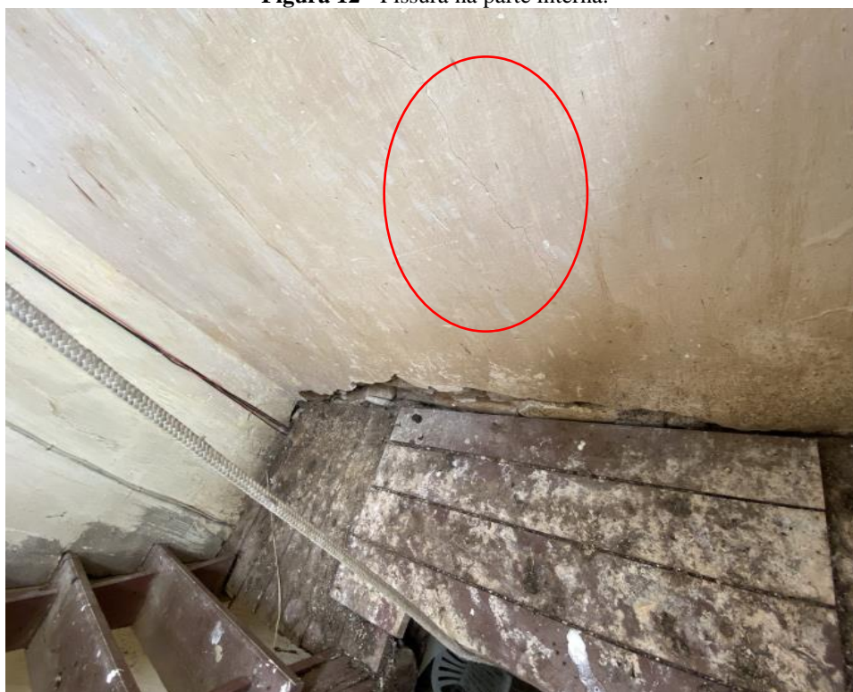
Figura 12 - Fissura na parte interna.
