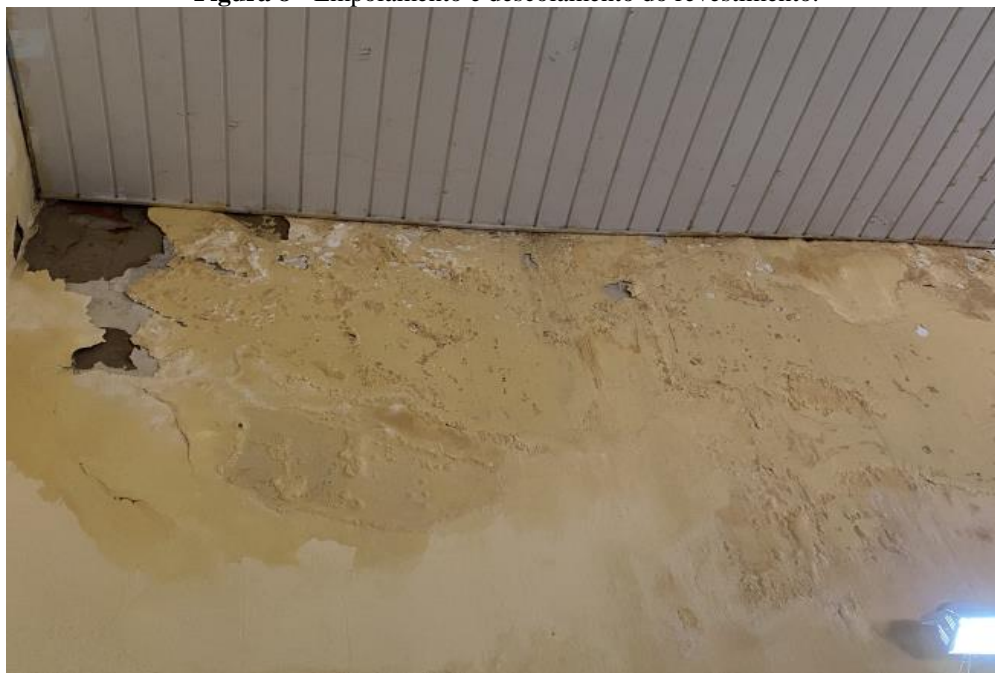
Figura 8 - Empolamento e descolamento do revestimento.
