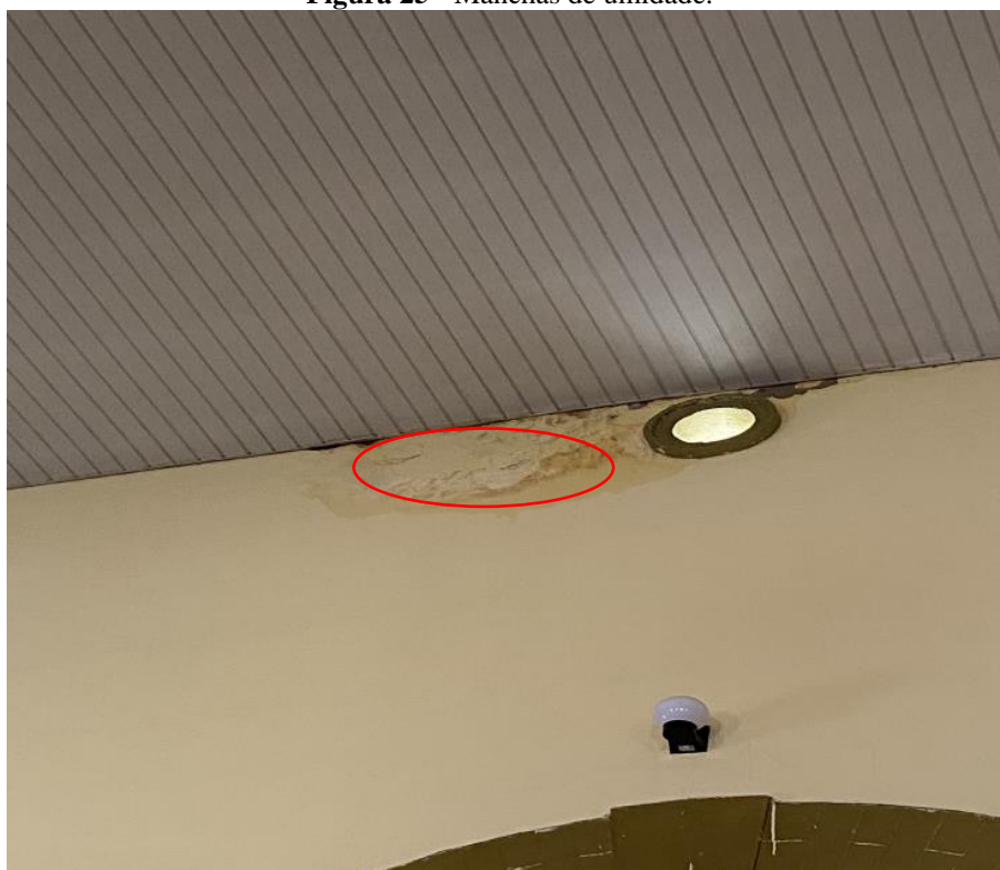
Figura 25 - Manchas de umidade.
