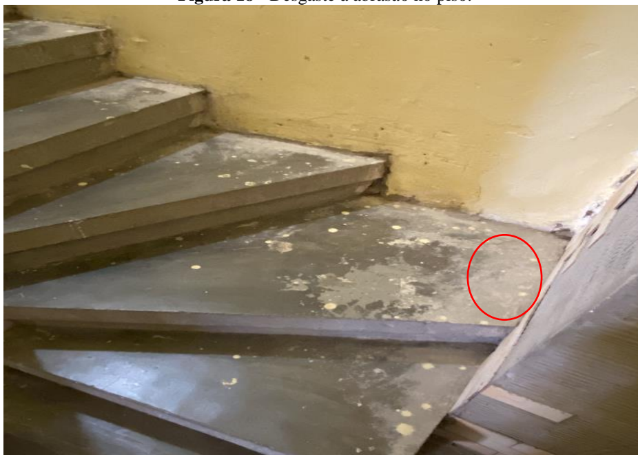
Figura 18 - Desgaste à abrasão no piso.
