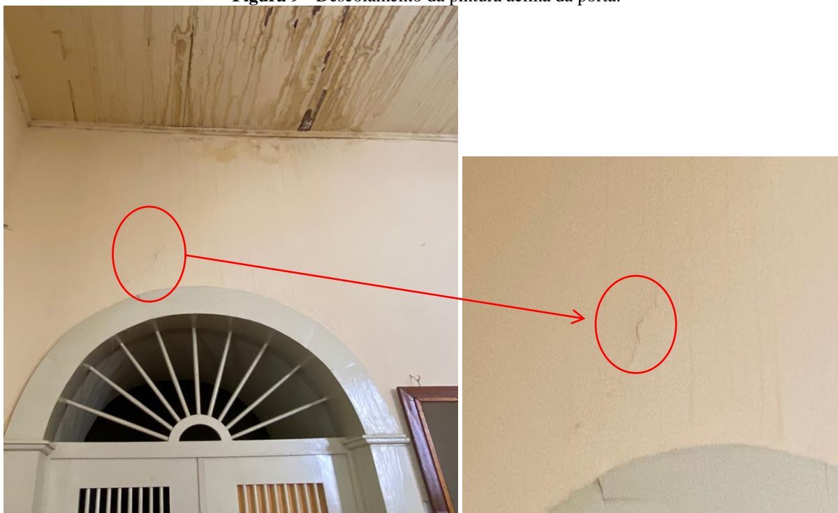
Figura 9 - Descolamento da pintura acima da porta.
