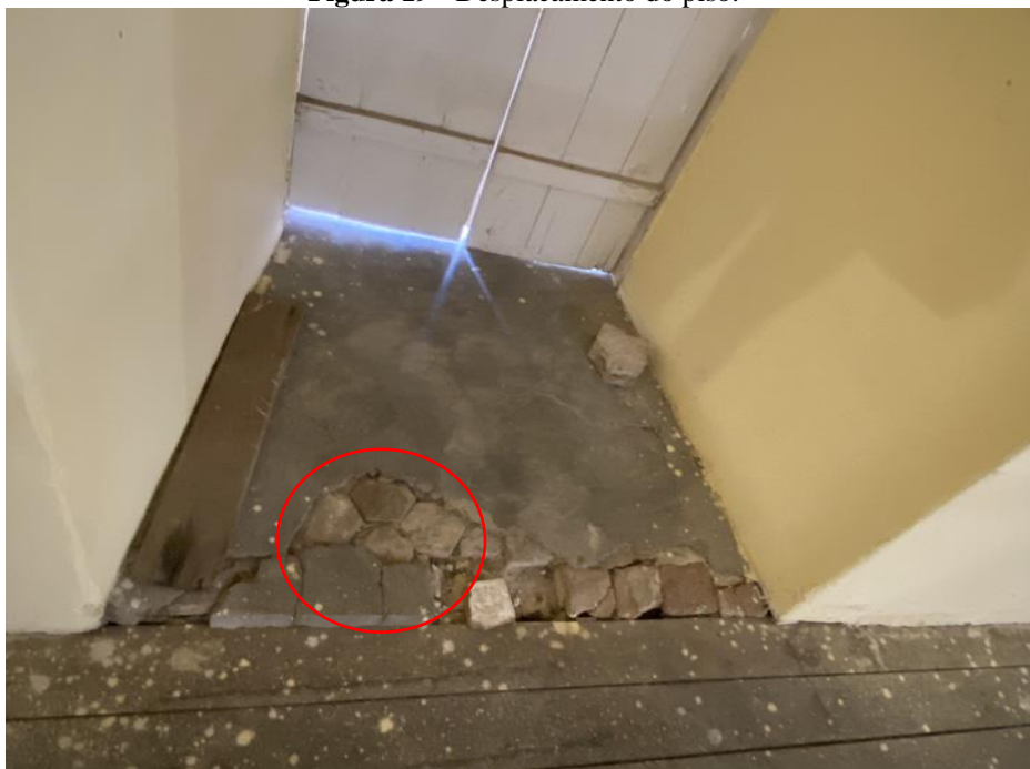
Figura 19 - Desplacamento do piso.
