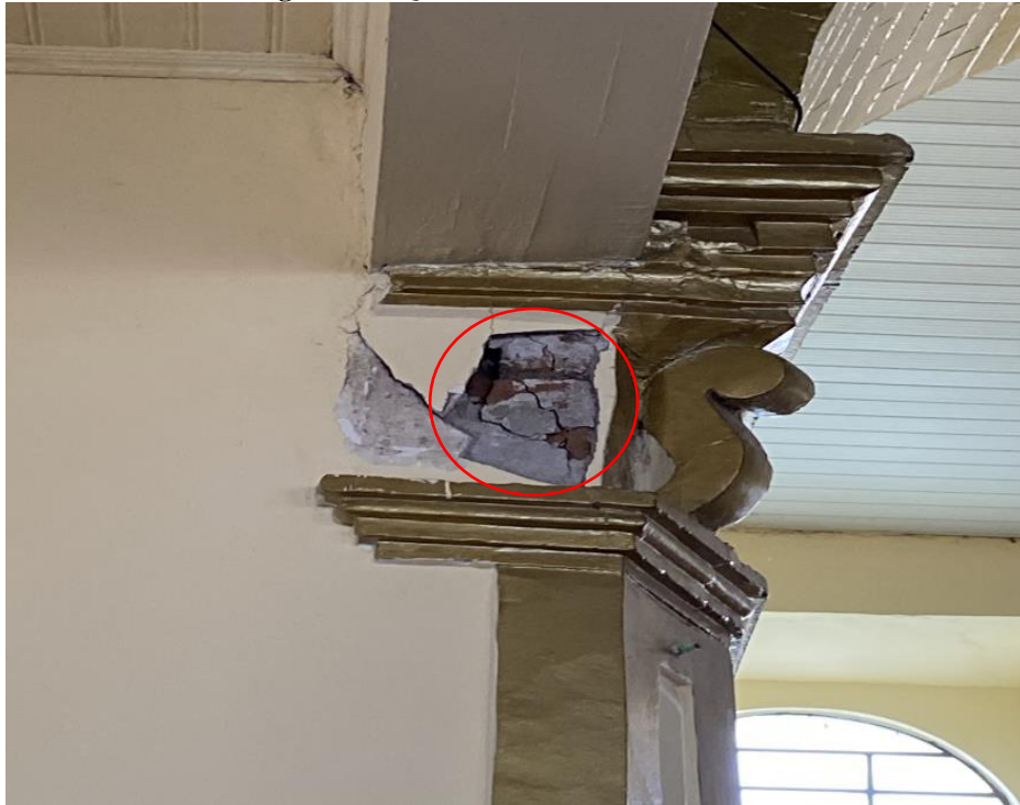
Figura 15 - Queda do revestimento e fissura.
