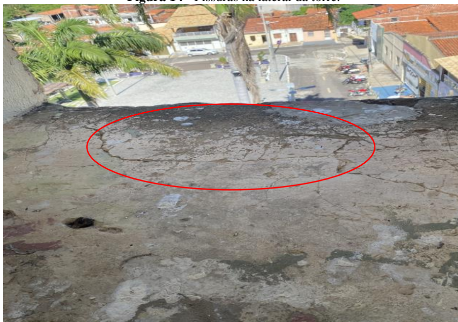
Figura 14 - Fissuras na lateral da torre.
