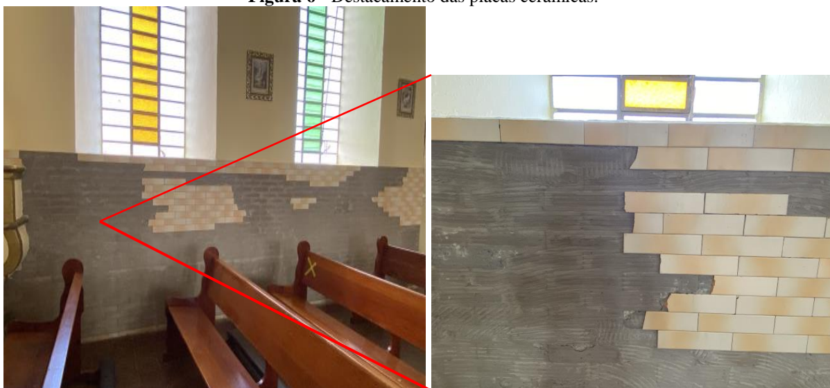
Figura 6 - Destacamento das placas cerâmicas.
