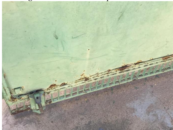
Figura 43 - Corrosão na esquadria metálica
