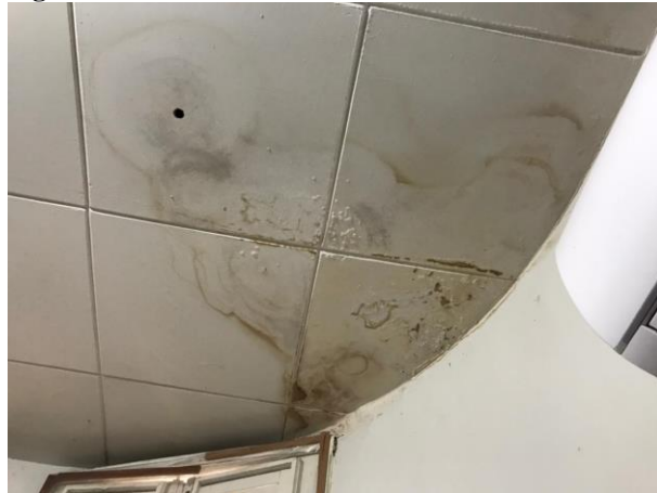
Figura 40 - Manchas no forro devido a falhas na cobertura
