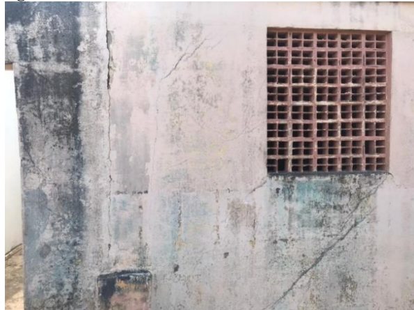
Figura 12 – Fachada com incidência de manchas escuras
