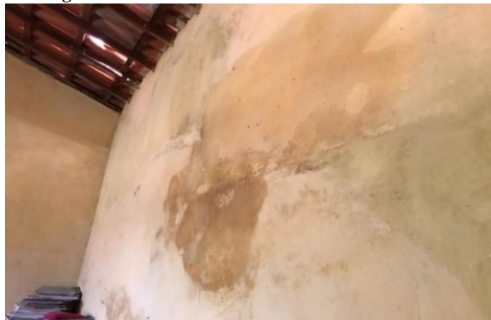
Figura 37 - Mancha na alvenaria devido a vazamentos
