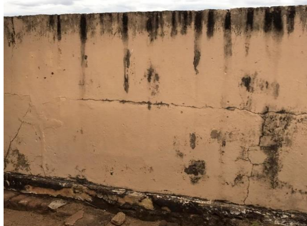
Figura 13 – Manchas escuras por falta de pingadeira no muro
