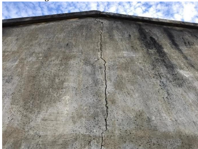
Figura 16 – Vista externa da rachadura
