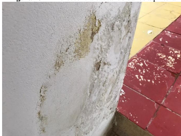
Figura 23 – Eflorescência causando danos a pintura
