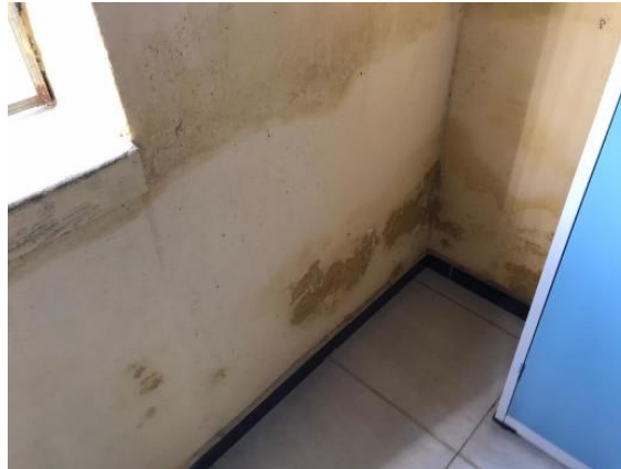
Figura 19 – Mancha na alvenaria devido a umidade ascendente
