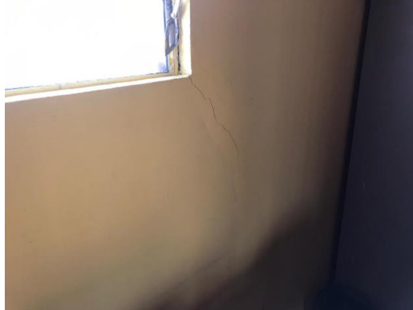
Figura 18 - Fissuras devido à falta de contravergas
