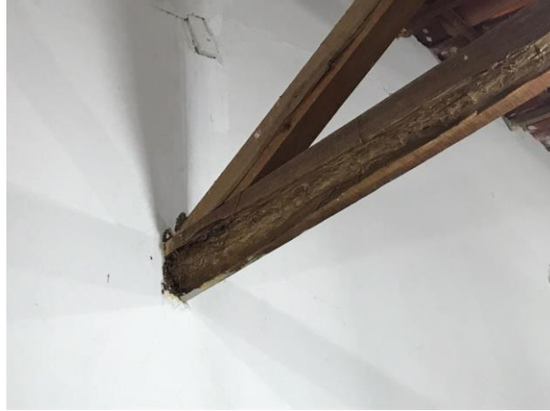
Figura 41 - Estrutura de madeira da cobertura danificada por cupins.
