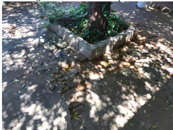
Figura 30 – Piso danificado por raízes
