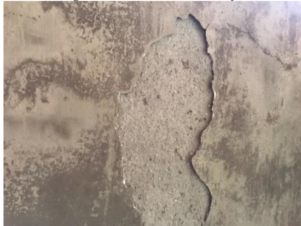
Figura 33 – Piso com delaminação
