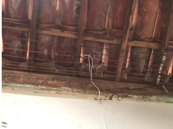
Figura 35 – Fios e ligação sem a proteção do eletroduto
