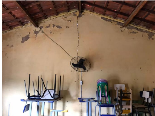
Figura 15 – Sala interditada devido a rachadura
