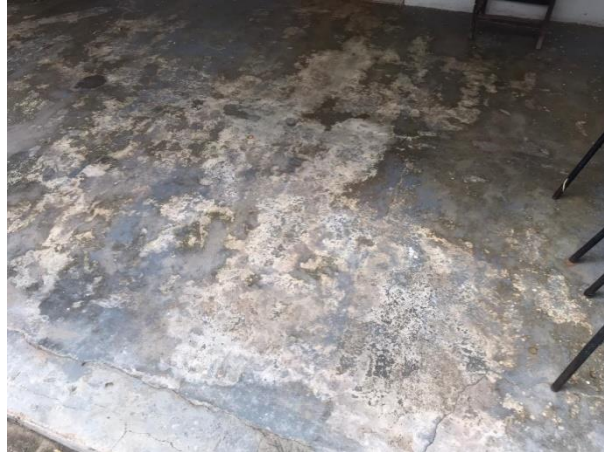
Figura 28 – Desgaste superficial do piso devido abrasão
