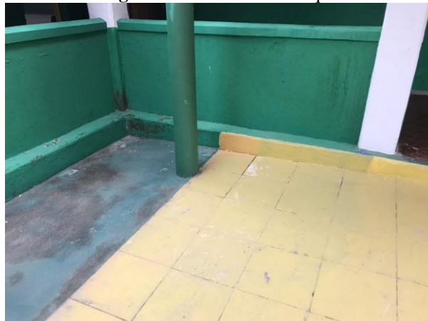
Figura 31 – Piso com recalque
