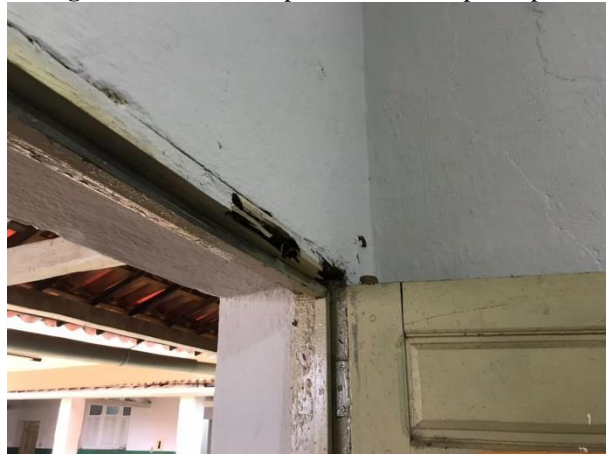
Figura 45 - Fôrma da porta danificada por cupins
