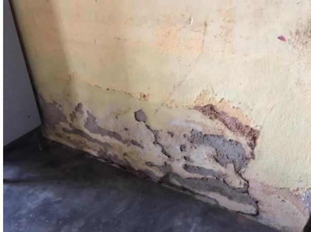
Figura 25 – Desagregação do revestimento com pulverulência
