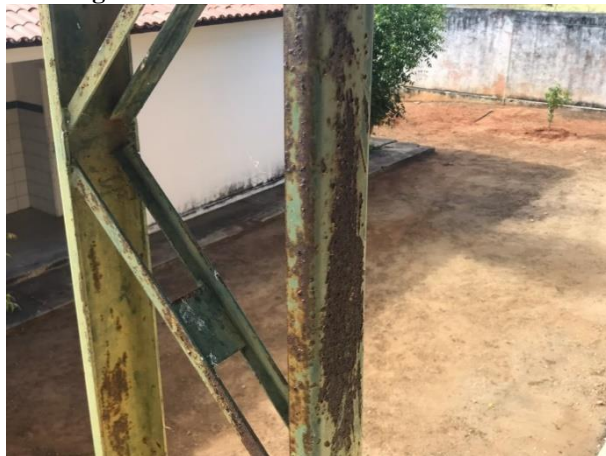
Figura 34 – Estrutura metálica com corrosão
