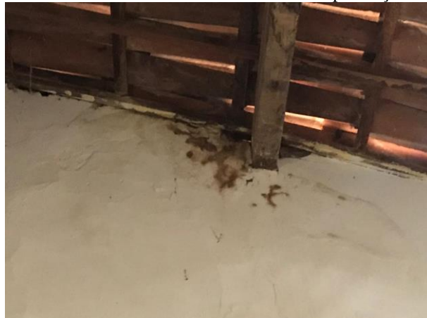
Figura 42 - Estrutura de madeira da cobertura com a presença de umidade
