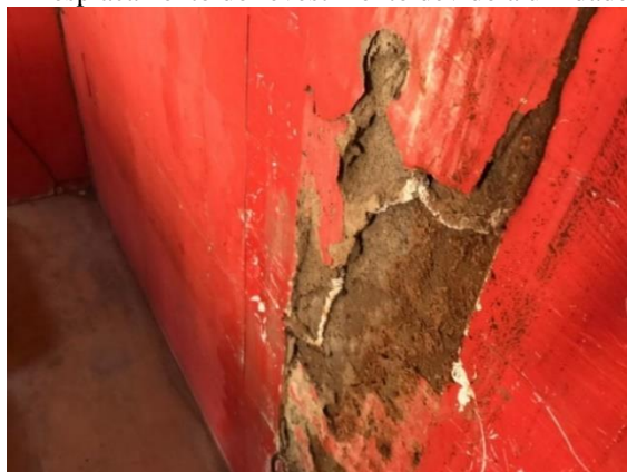
Figura 20 – Desplacamento do revestimento devido a umidade ascendente
