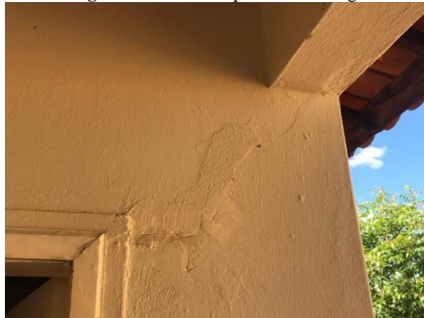
Figura 17 – Fissuras por falta de verga
