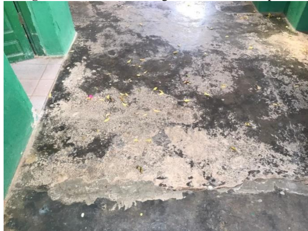
Figura 29 – Piso com desgaste a abrasão e reparos
