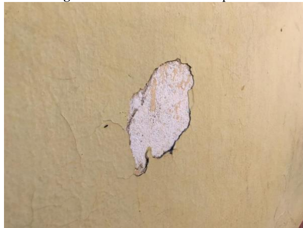
Figura 27 – Descascamento da pintura
