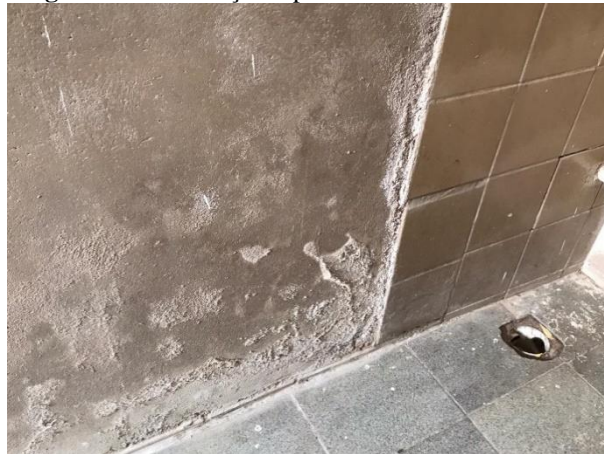
Figura 24 – Presença do pó fino sobre o revestimento
