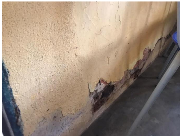
Figura 21 – Descolamento do revestimento devido a umidade ascendente
