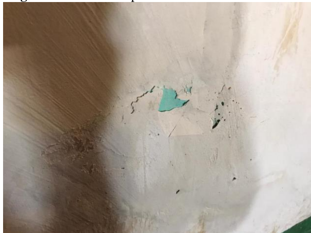
Figura 26 – Bolha na pintura causando descascamento
