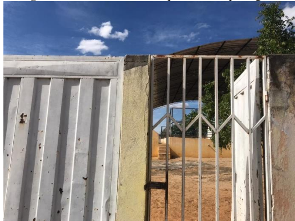
Figura 44 - Corrosão em esquadrias desprotegidas
