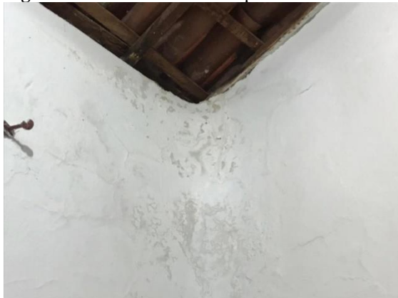
Figura 39 - Manchas causadas por falhas na cobertura
