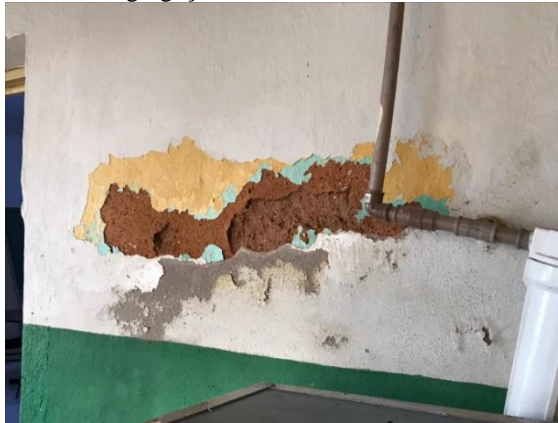
Figura 38 - Desagregação do revestimento devido a vazamentos
