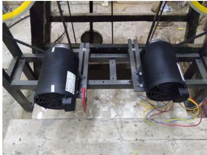
Figura 22: Motores fixados na estrutura
