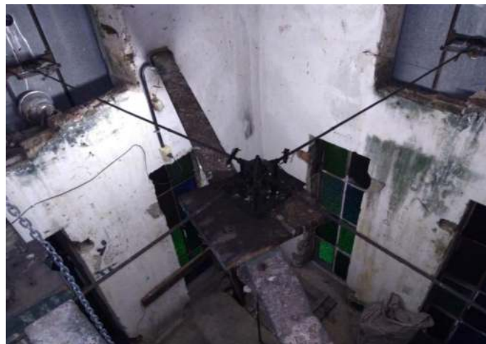
Figura 6: Transmissão mecânica dos ponteiros conectada a os mostradores
