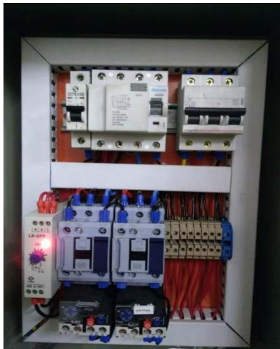
Figura 27: QUADRO DE COMANDO E FORÇA
