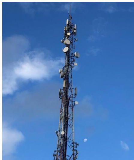
Figura 1 - Torre com antenas destinadas a múltiplos serviços
