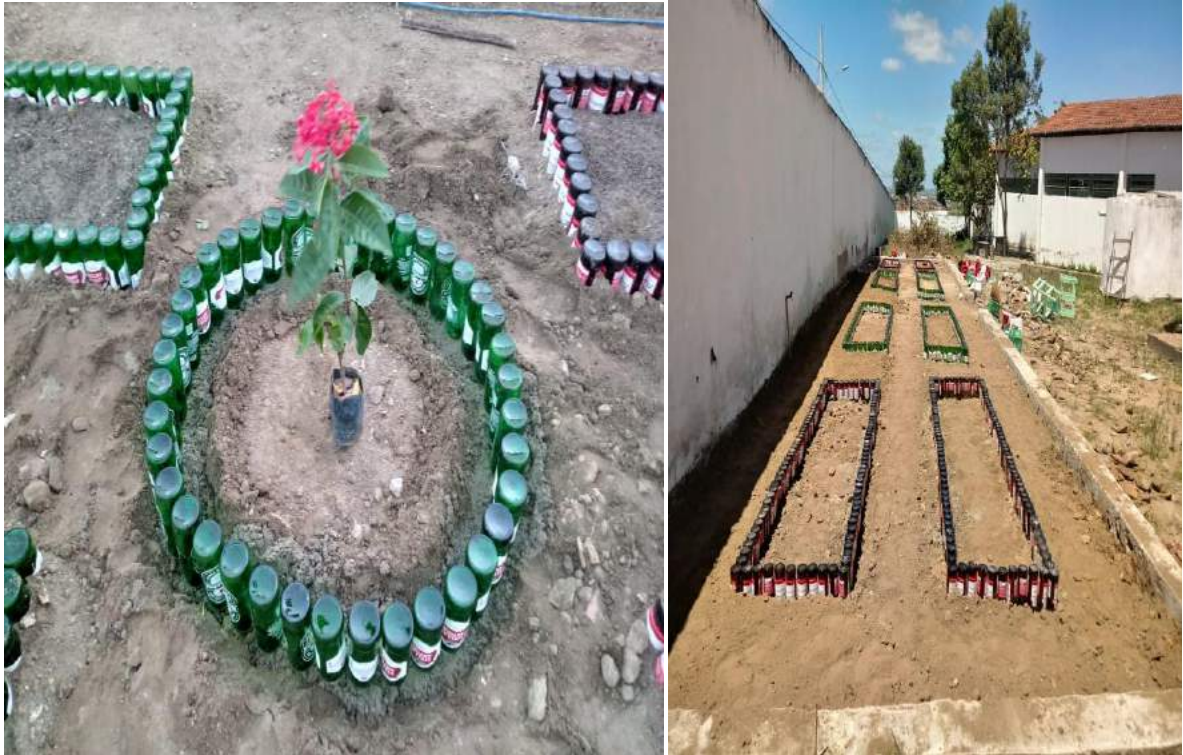
APÊNDICE I - Imagem real do projeto sendo executado: Estruturação das hortas com garrafas de vidro.
