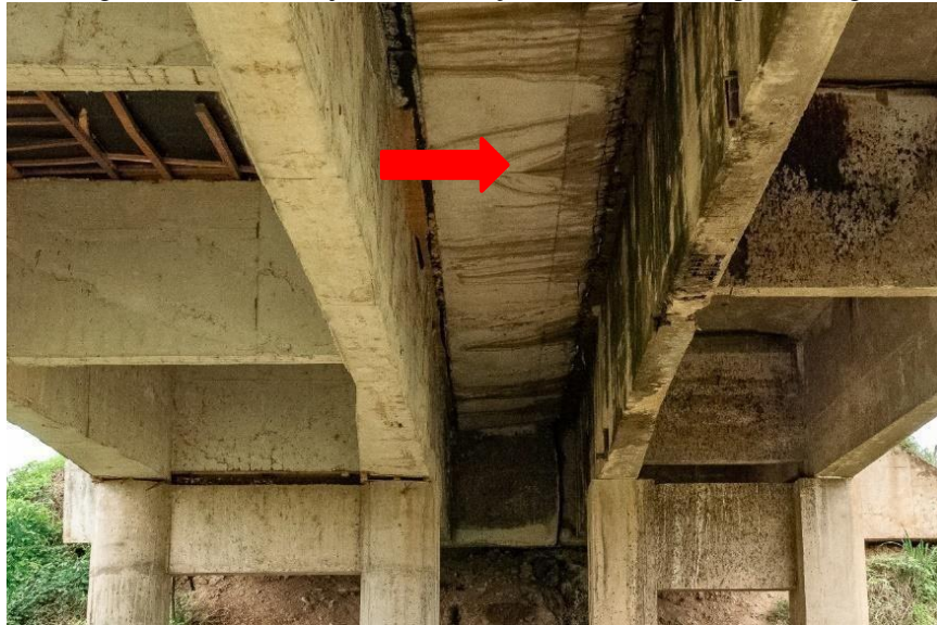
Figura 30 – Falhas na junta de dilatação - face interna da ponte antiga.
