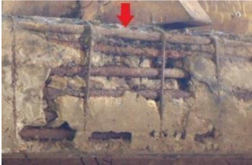
Figura 11 – Corrosão em viga de ponte de concreto armado.
