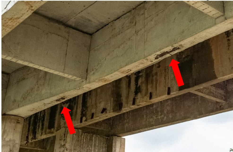
Figura 34 – Falha no cobrimento da armadura na face inferior da longarina.
