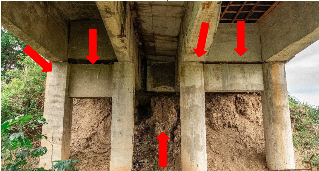
Figura 38 – Falta de aparelho de apoio e falha na transição entre a rodovia e a ponte com extremidade em balanço.
