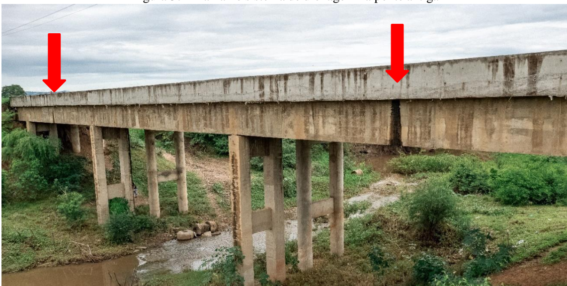
Figura 37 – Falha no sistema de drenagem na ponte antiga
