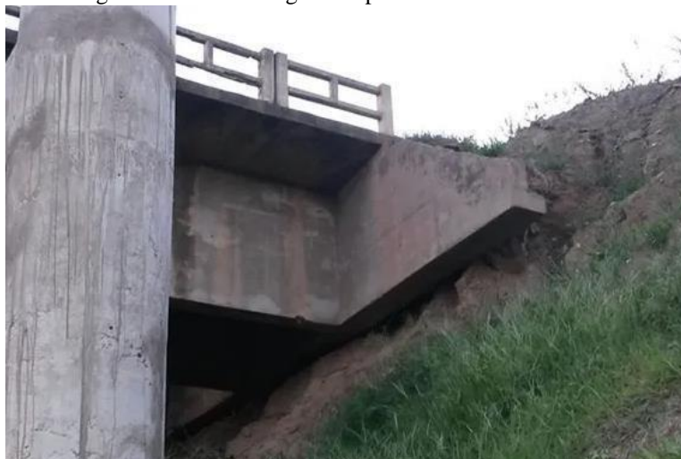
Figura 26 – Ponte antiga sobreposta livremente no talude.
