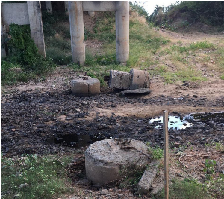
Figura 16 – Ruínas de pilares encontradas na parte inferior da ponte sobre o Rio Piranhas
