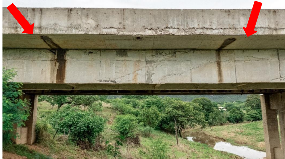
Figura 36 – Falha no sistema de drenagem no lado ampliado da ponte
