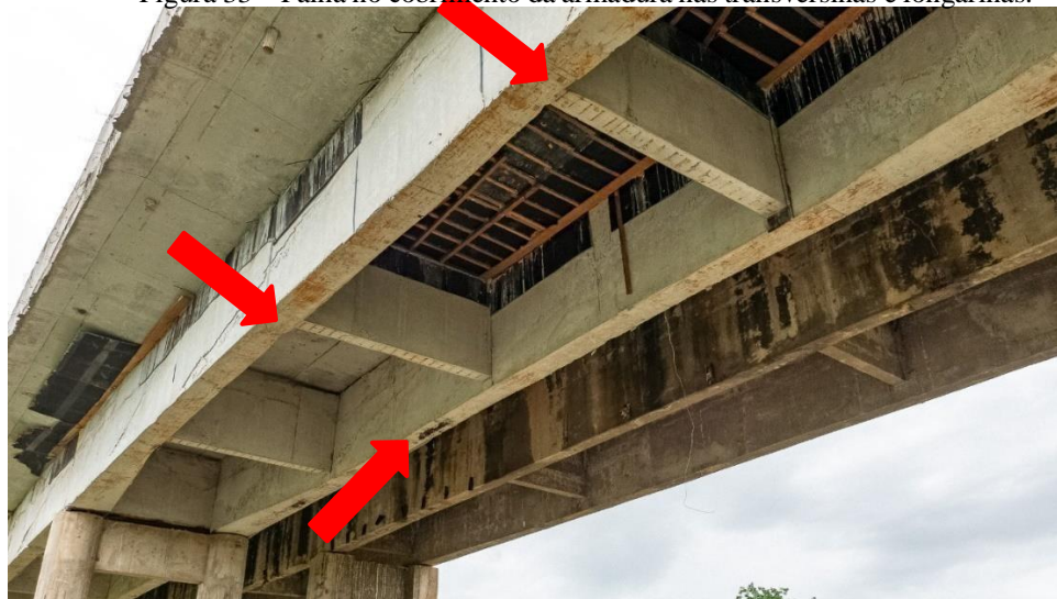
Figura 33 – Falha no cobrimento da armadura nas transversinas e longarinas.
