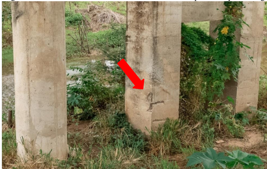
Figura 35 – Falha no cobrimento da armadura em um dos pilares da ponte antiga
