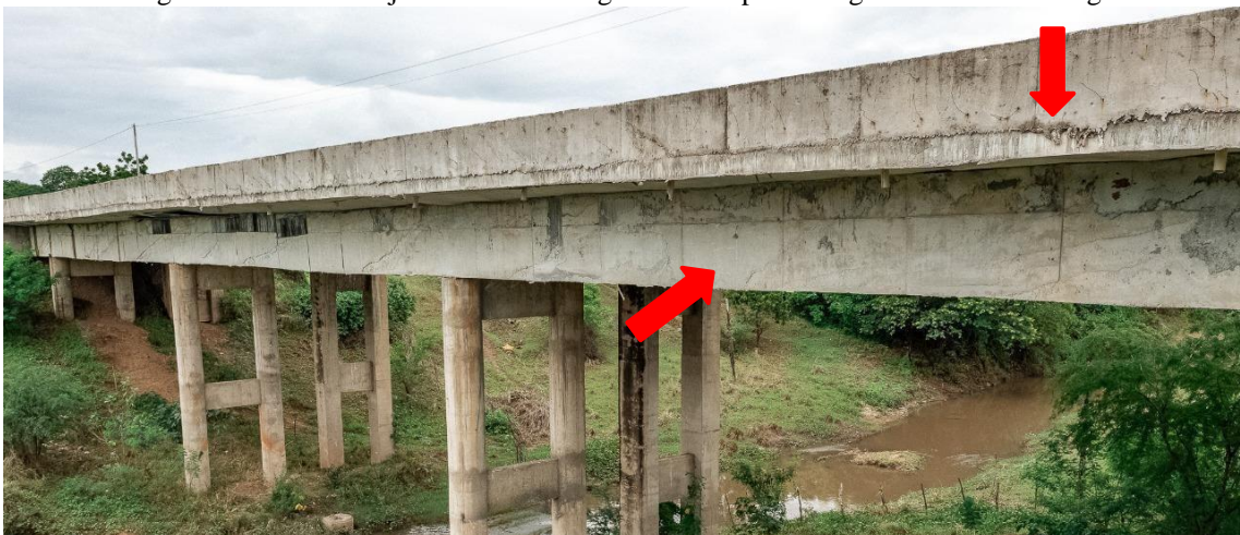
Figura 31 – Falha nas juntas de concretagem - lado oposto do guarda-rodas e na longarina.
