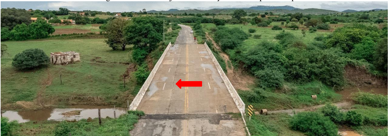
Figura 29 – Falha da junta de dilatação - vista superior da ponte
