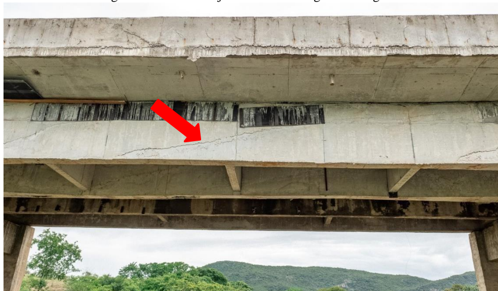
Figura 32 – Falha nas juntas de concretagem na longarina.
