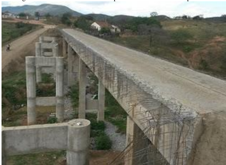
Figura 24 – Vista frontal da obra da ponte sobre o Rio Piranhas paralisada.
