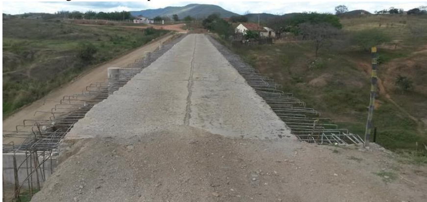
Figura 23– Ponte parcialmente demolida sobre o Rio Piranhas.
