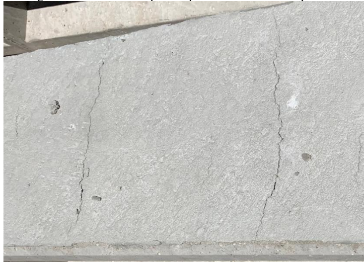
Figura 1 – Fissuras em pilares pré-fabricados na empresa A.
