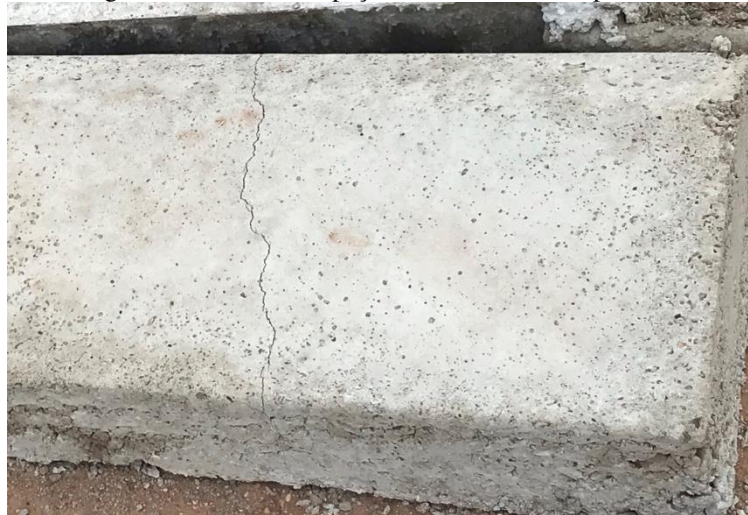
Figura 2 – Fissuras em peças de meio-fio na empresa B.
