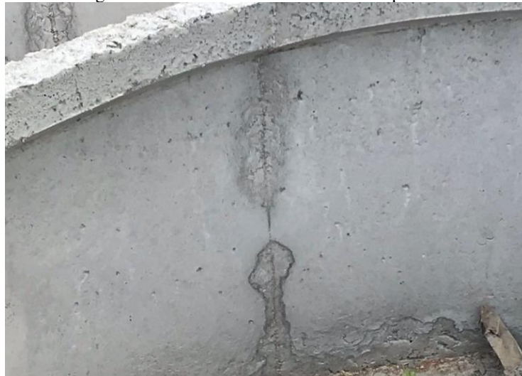
Figura 12 – Manchas em manilhas na empresa B.
