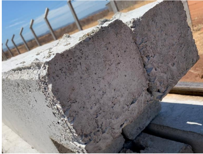
Figura 7 – Ninhos de concretagem em vigas de contraventamento na empresa A.
