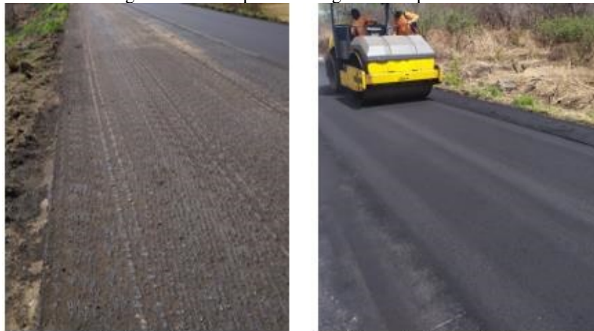
(a) Pavimento fresado.
