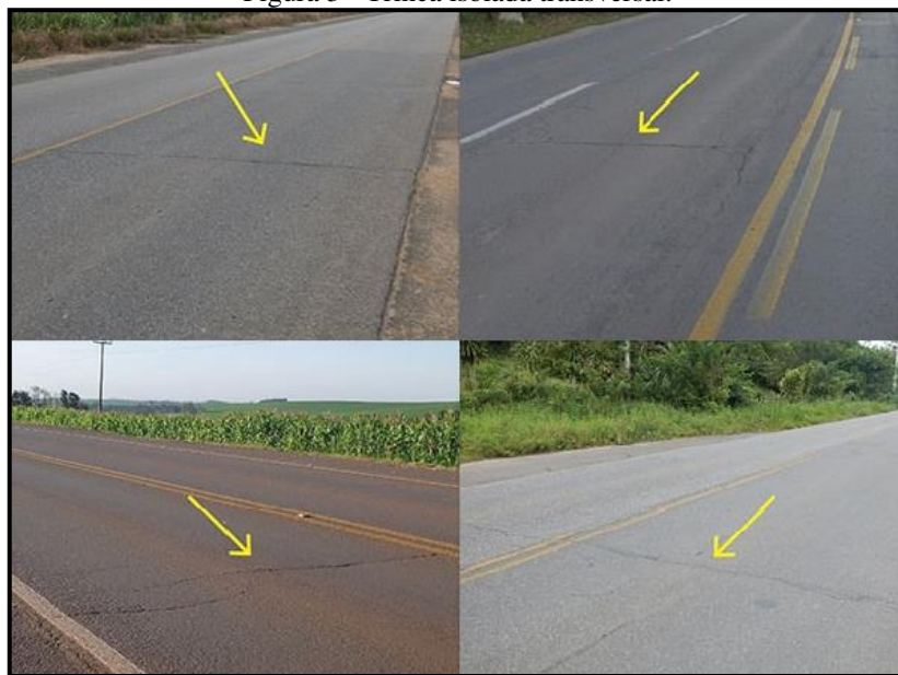
Figura 3 - Trinca isolada transversal.
