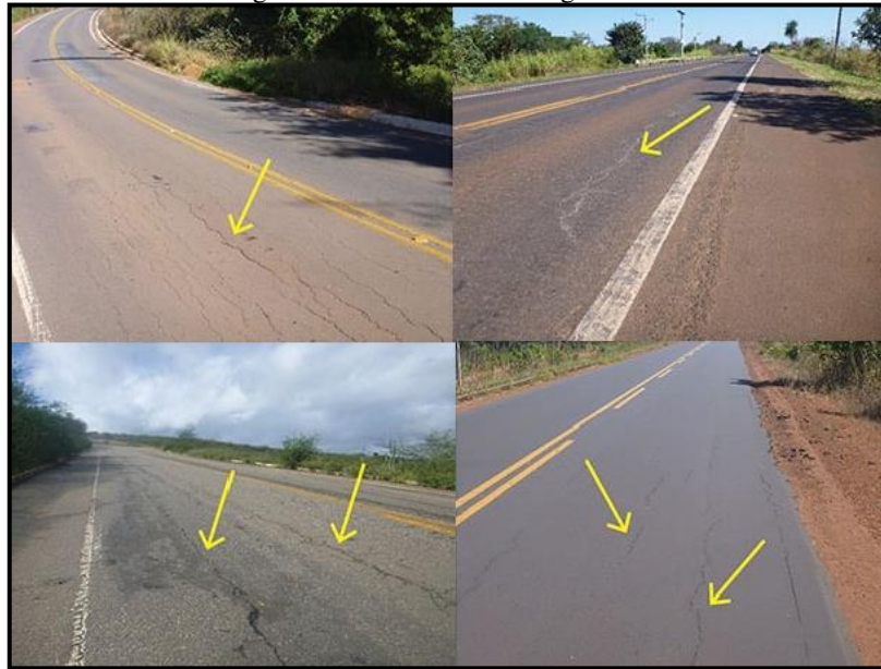
Figura 4 - Trinca isolada longitudinal.
