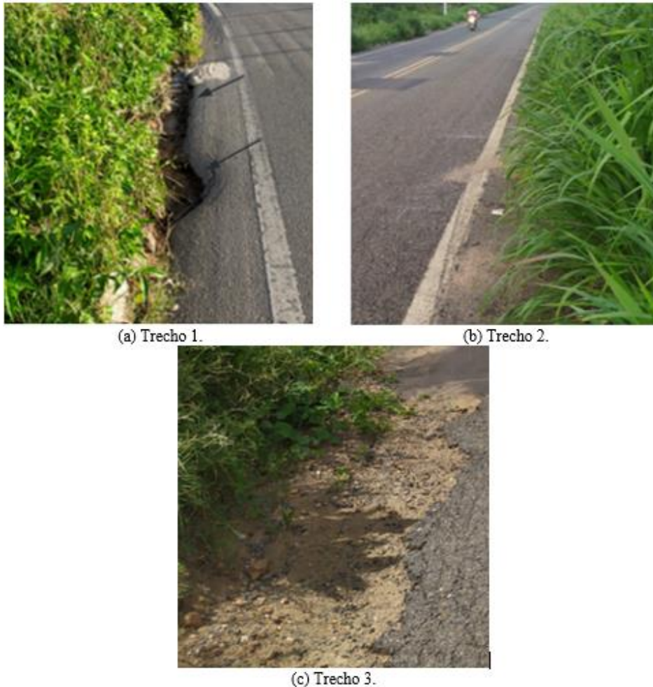
Figura 18 - Falta de manutenção da rodovia.
