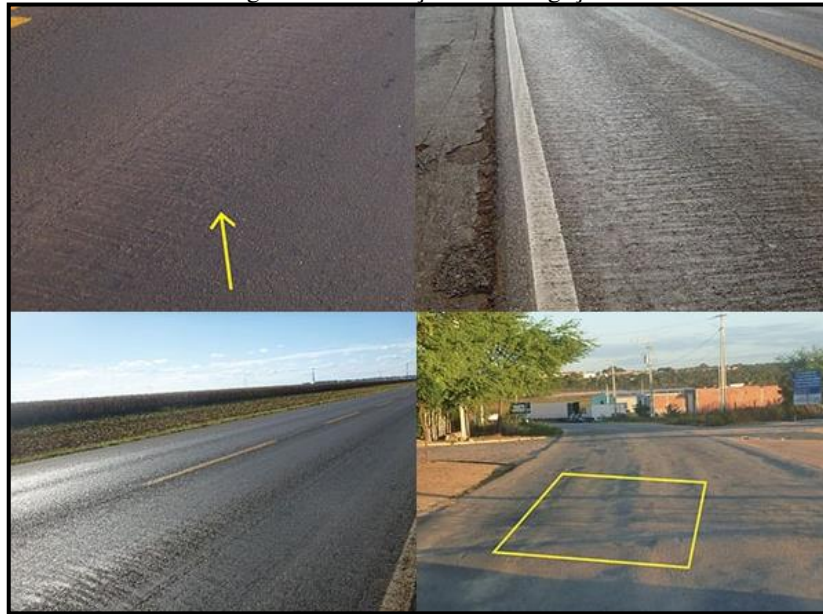
Figura 9 - Ondulação ou corrugação.
