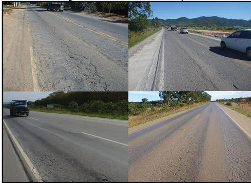
Figura 8 - Afundamento de consolidação.
