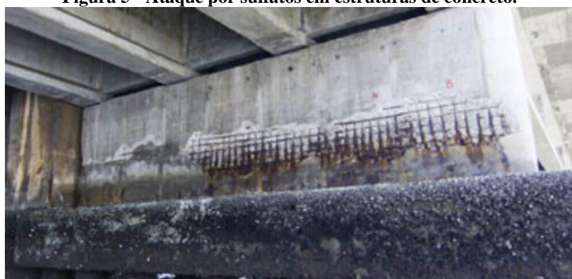
Figura 5 - Ataque por sulfatos em estruturas de concreto.
