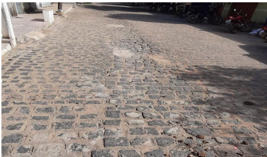
Figura 11 – Trecho com afundamento da pavimentação acima da rede de esgoto.
