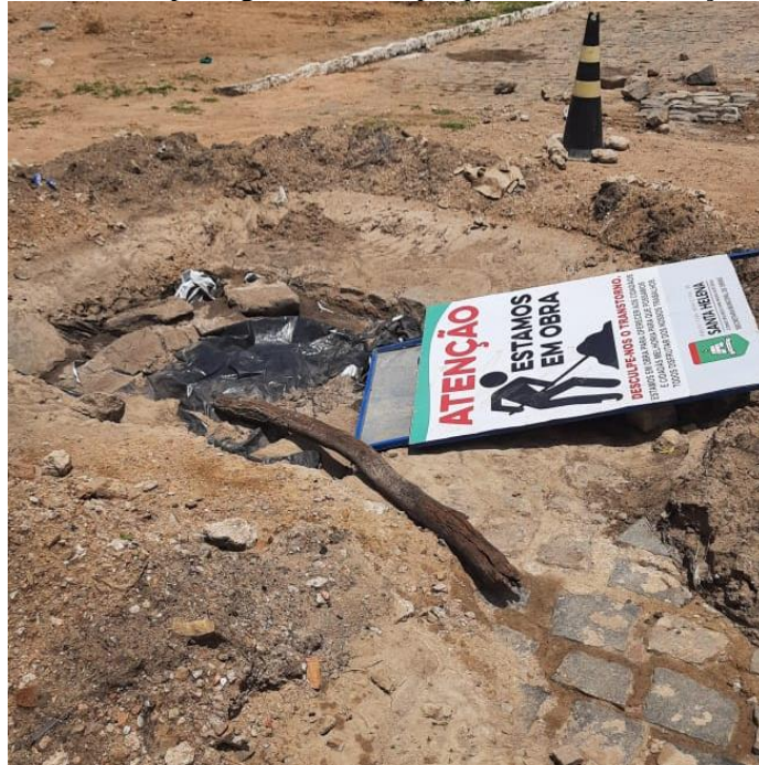
Figura 10 – Caixa de passagem com tampa quebrada e sinalização derrubada.
