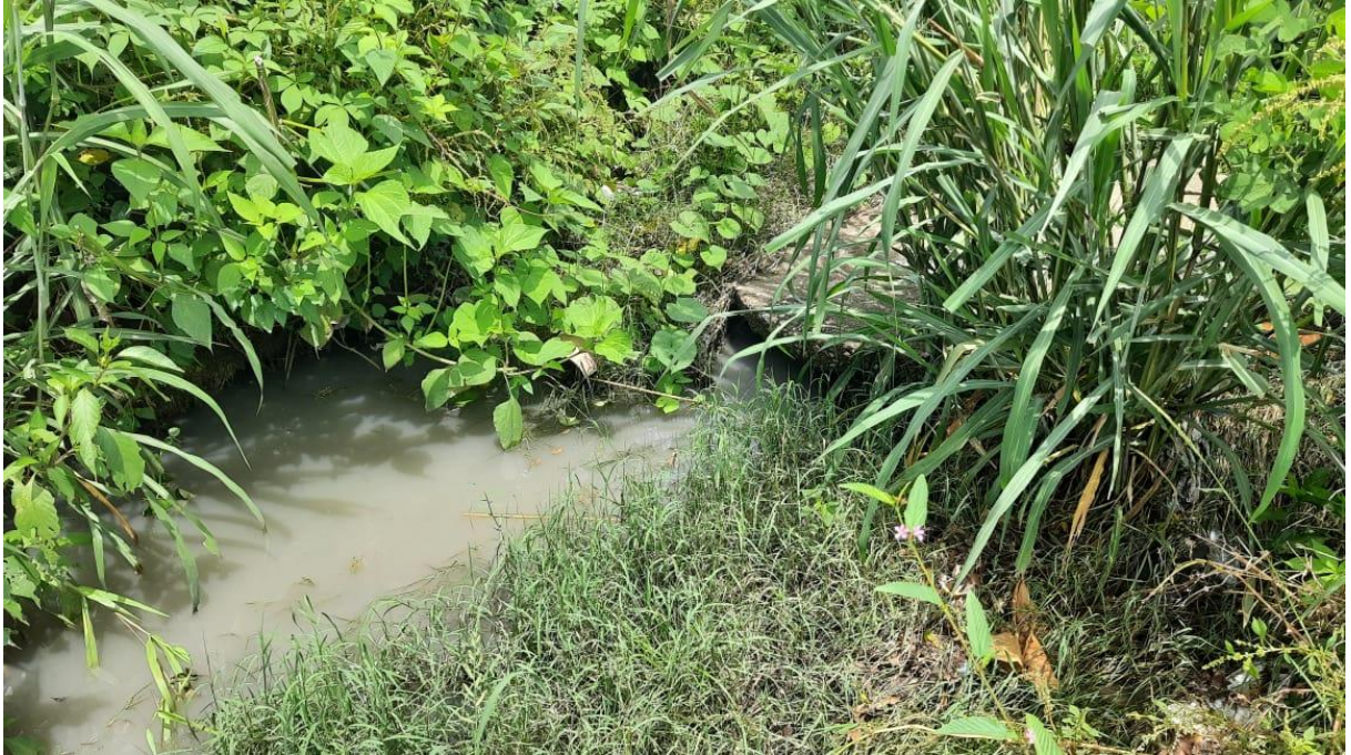
Figura 14 – Ponto de despejo de esgoto bruto 2.
