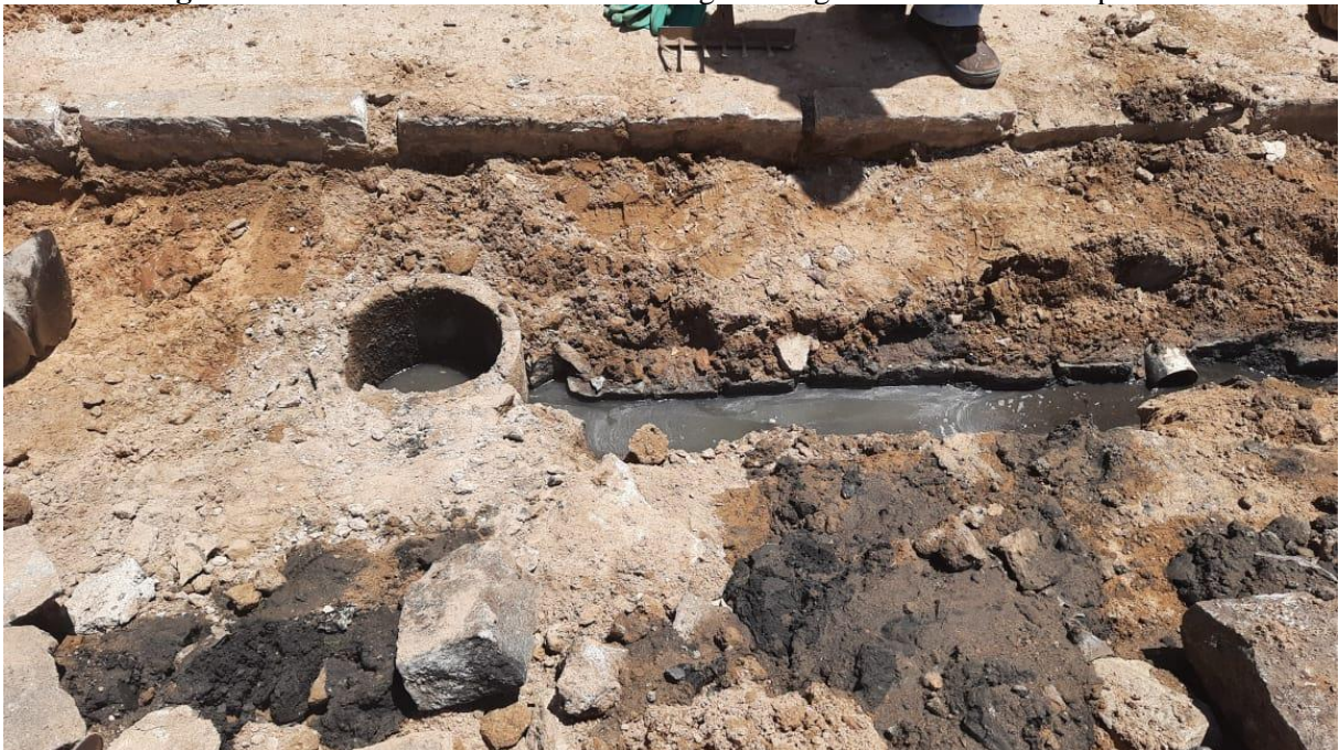
Figura 9 – Sistema arcaico de coleta de esgoto e órgão acessório fora do padrão.
