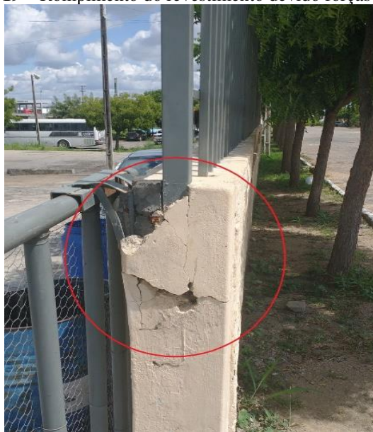
Figura 19 – Rompimento do revestimento devido forças internas.
