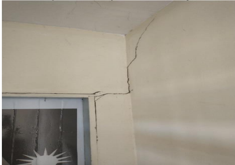
Figura 18 – Fissuração devido falta de verga.
