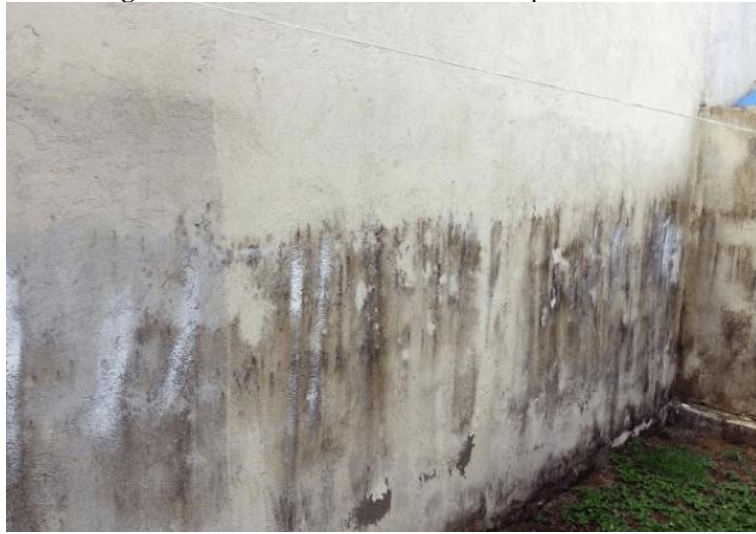
Figura 3 – Manchas e bolores causados por umidade.
