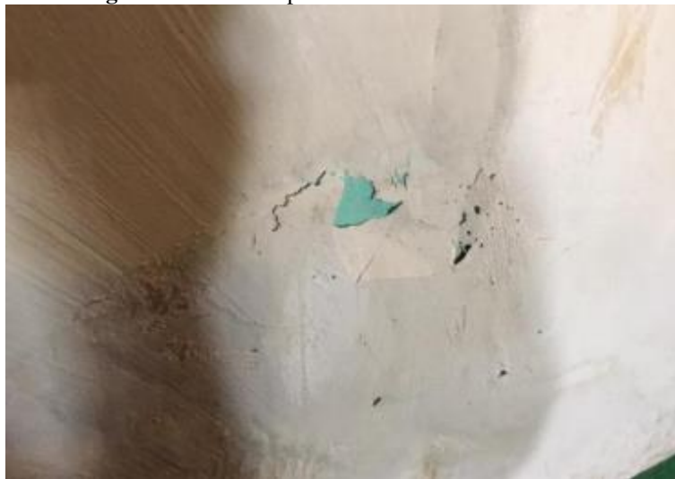
Figura 7 – Bolha na pintura causando descascamento.
