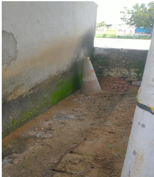
Figura 26 – Lodo e manchas escuras devido à falta de escoamento da água da chuva.
