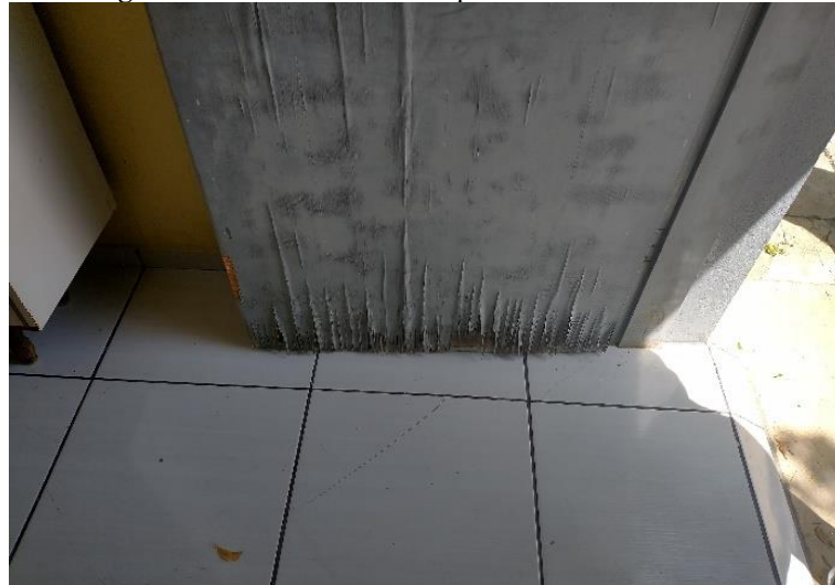
Figura 31 – Inchamento de esquadria devido à umidade.
