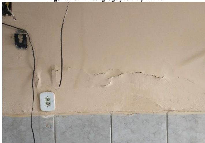
Figura 23 – Desagregação da pintura.
