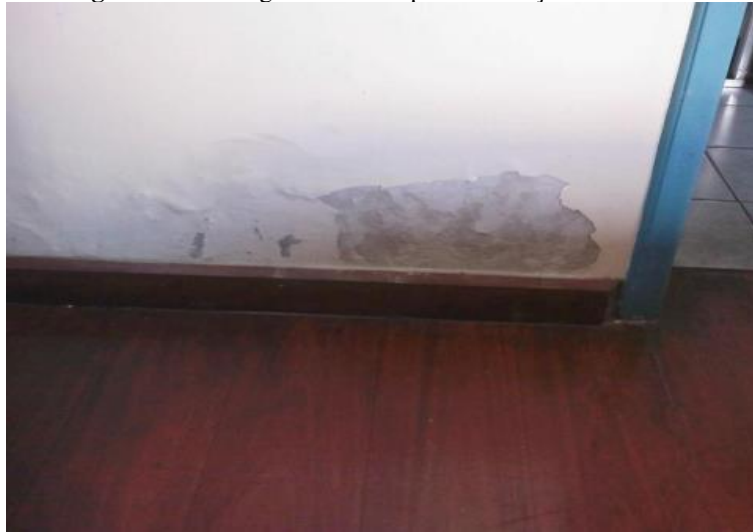
Figura 2 – Patologias causadas pela infiltração ascendente.
