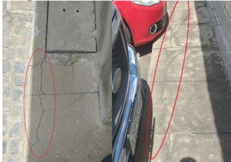
Figura 20 – Fissuras na calçada interna devido ao recalque.
