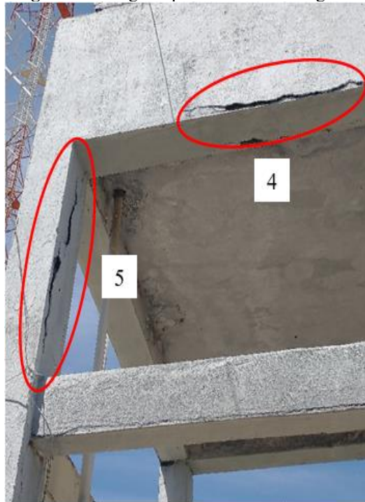
Figura 34 – Vigas e pilares da caixa d'água II.
