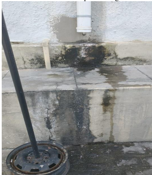
Figura 24 – Lodo e mofo devido à falta de estanqueidade água do sistema de ar-condicionado.
