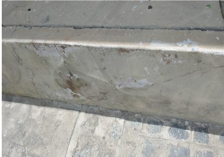
Figura 27 – Pulverulência e descascamento da pintura devido a umidade.
