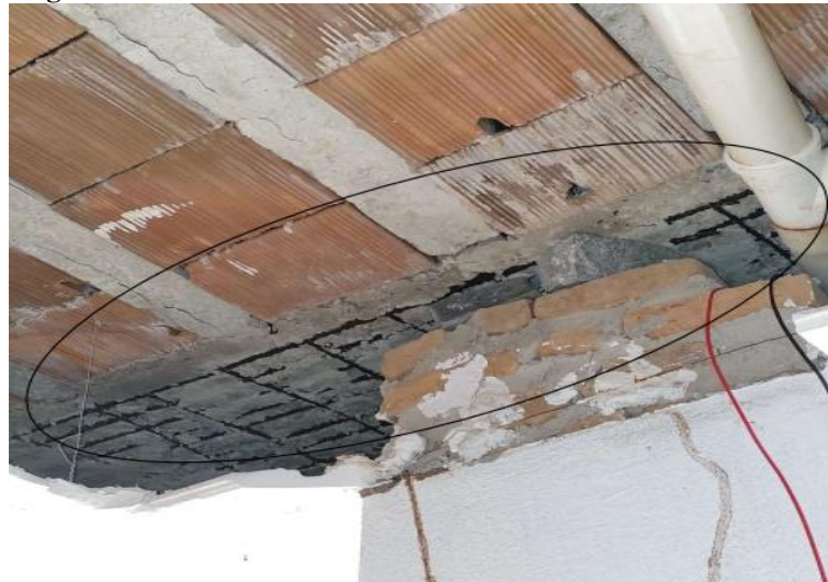
Figura 11 – Processo de corrosão em estruturas de concreto armado.
