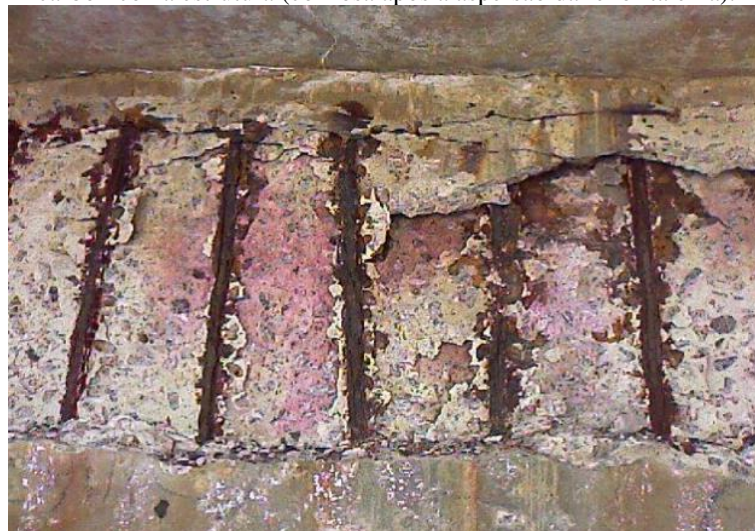
Figura 12 – Corrosão com perda de seção das armaduras de viga com indicação da não penetração do gás carbônico na estrutura (cor rosa após a aspersão da fenolftaleína).
