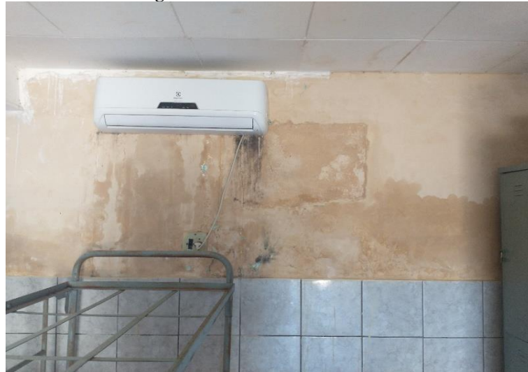
Figura 28 – Umidade na alvenaria.
