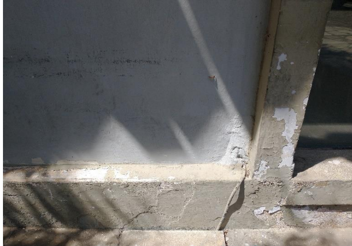
Figura 22 – Descascamento da pintura devido a condições agressivas.
