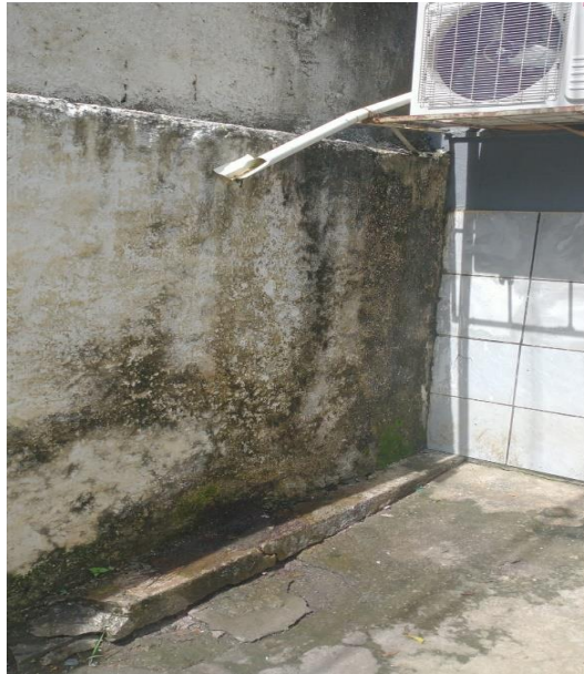
Figura 25 – Parede com alta incidência de manchas escuras e lodo.
