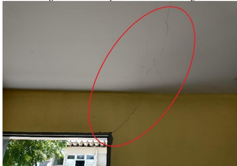
Figura 17 – Fissuração devido à falta de verga.
