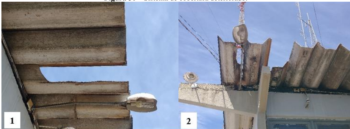
Figura 30 – Sistema de cobertura deteriorado.
