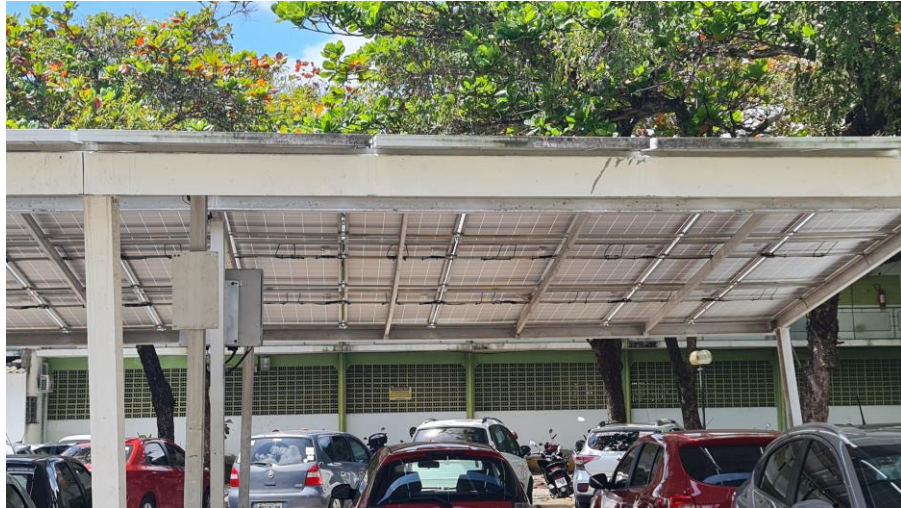
Figura 8 – Visualização das Conexões Elétricas dos Painéis
