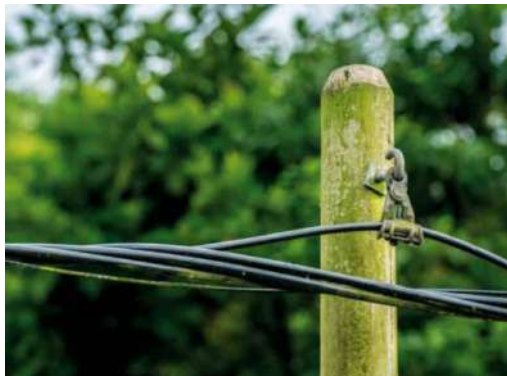
Figura 14 – Rede secundária área em cabos multiplexados.
