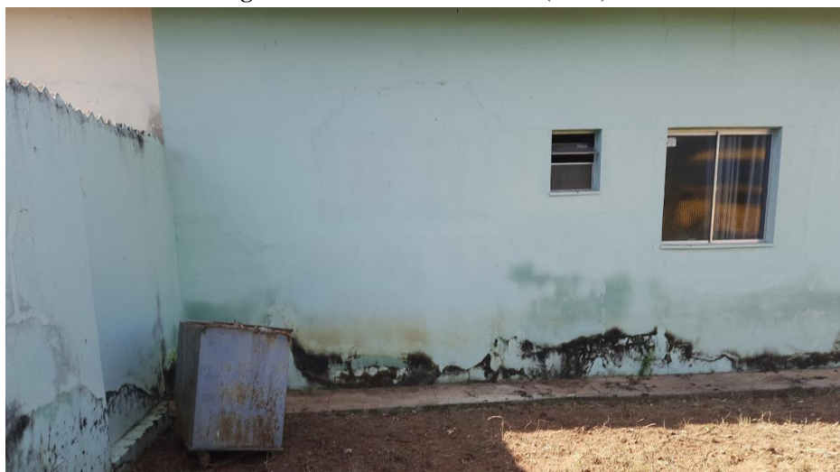
Figura 7 – Manchas esverdeadas (mofo).
