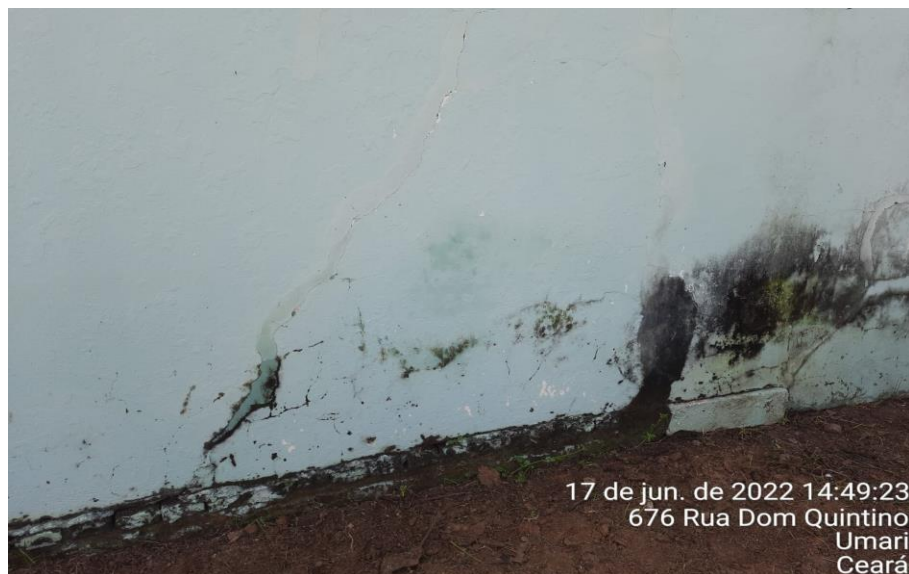
Figura 6 – Incidência de manchas escuras na fachada.
