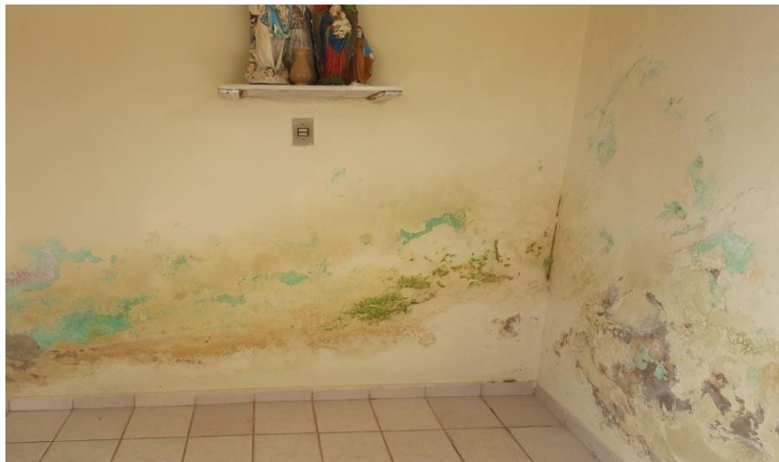
Figura 18 – Descascamento na Pintura.
