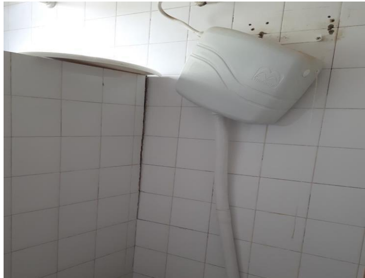
Figura 29 – Caixa de descarga quebrada.
