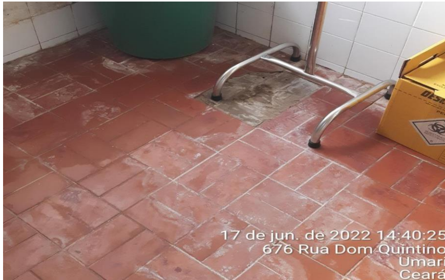
Figura 24 – Eflorescência no piso.
