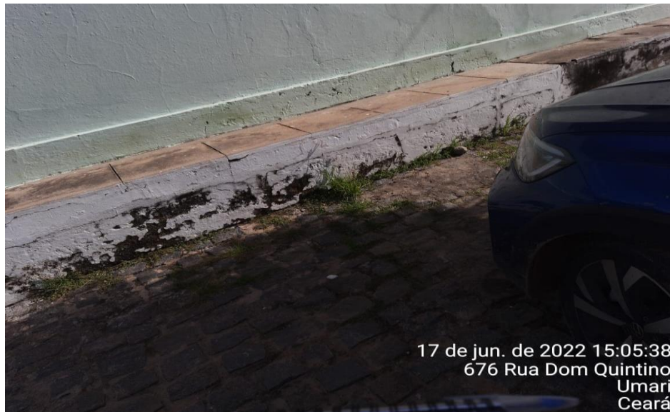
Figura 9 – Presença de vegetação na Fachada.
