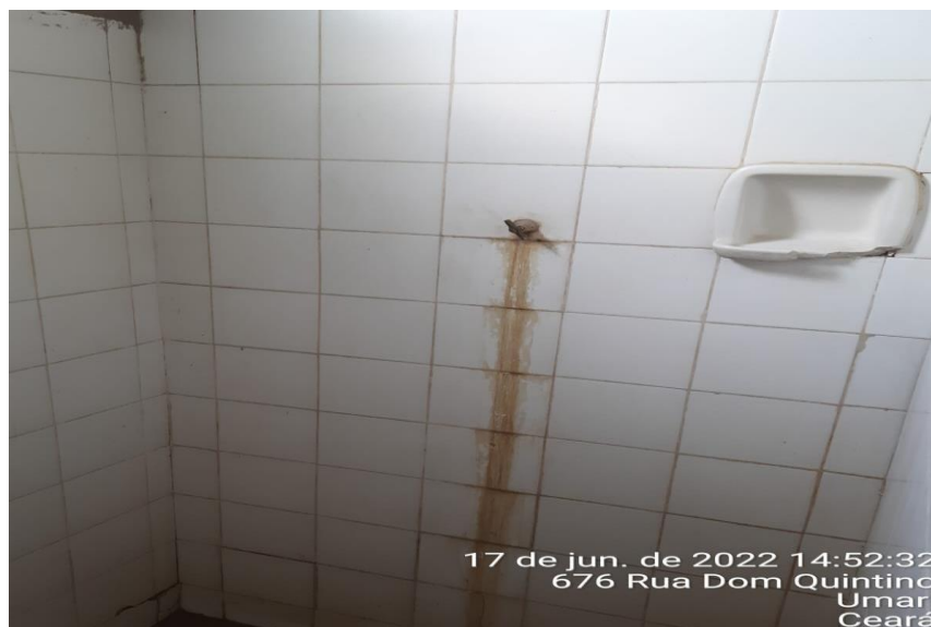
Figura 27 – Manchas da cerâmica devido a vazamento.
