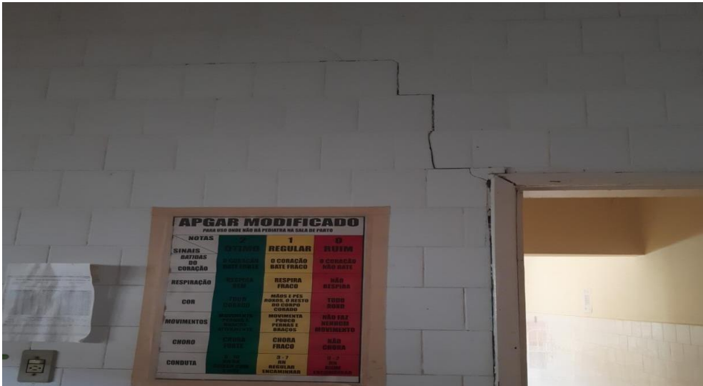
Figura 13 – Fissuras causadas por ausência de vergas.
