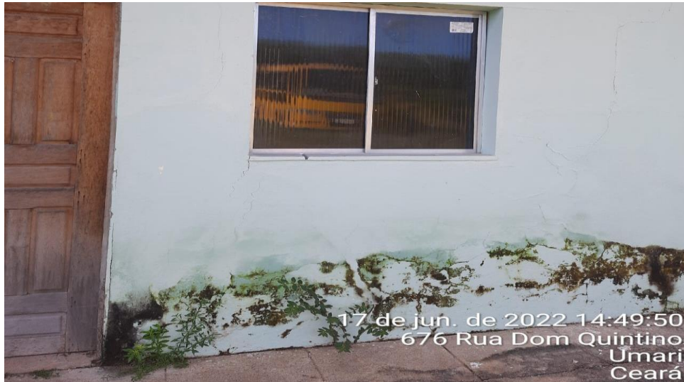
Figura 8 – Manchas esverdeadas (mofo).
