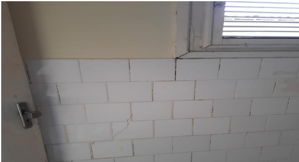
Figura 14 – Fissuras causadas pela ausência de contravergas.
