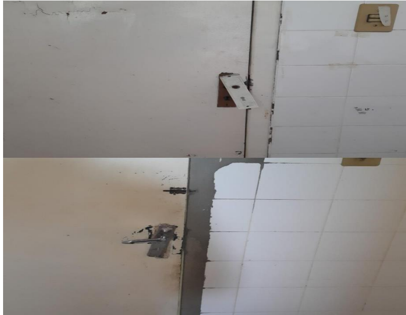
Figura 37 – Fechaduras com defeito.
