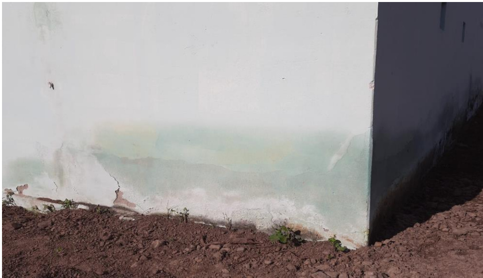
Figura 16 – Umidade ascendente na parte externa.
