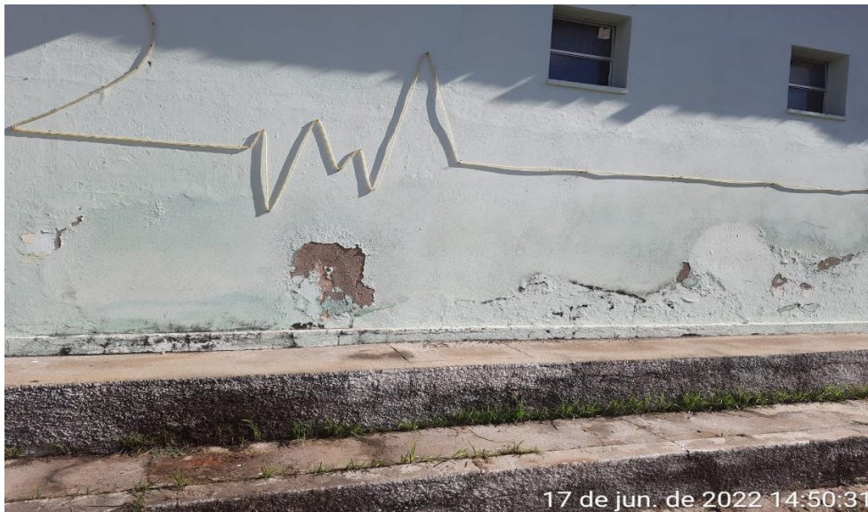
Figura 11 – Descascamento e bolhas na pintura.
