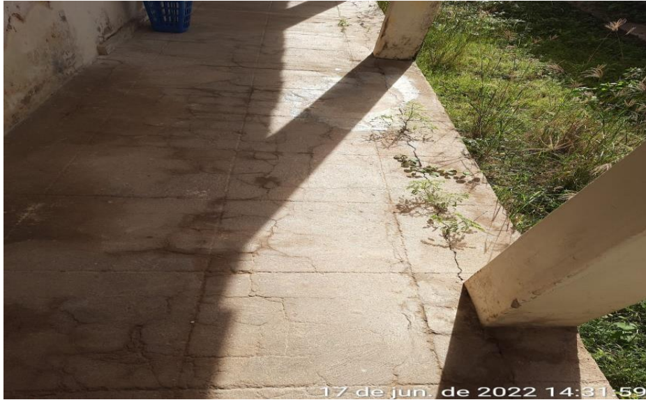
Figura 22 – Piso com trincas.
