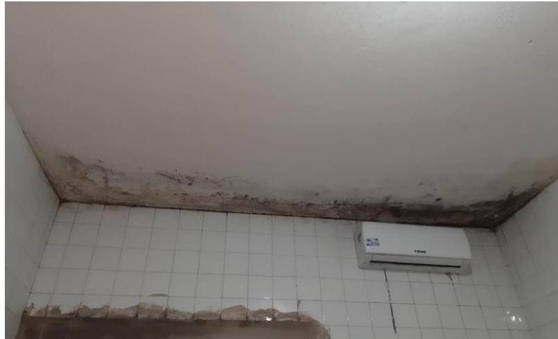
Figura 33 – Manchas no forro devido ao ar-
