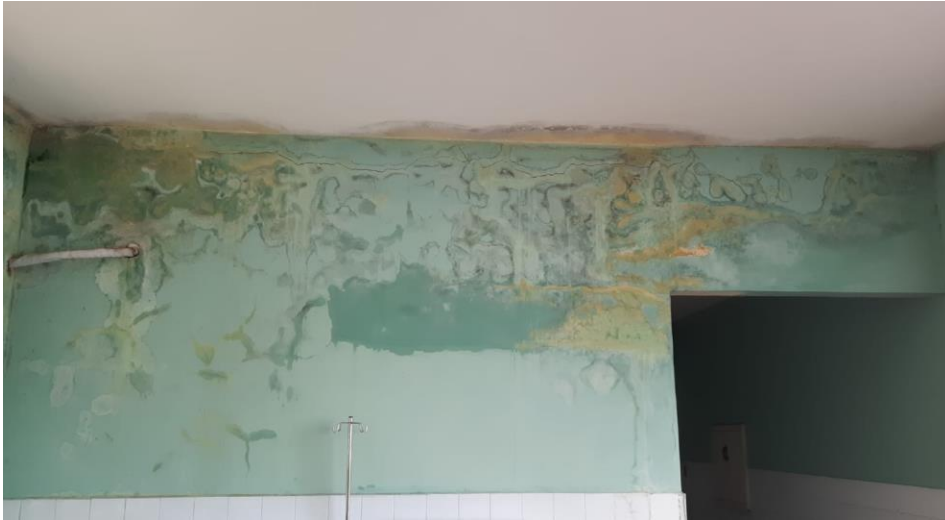
Figura 12 – Infiltração ocasionada por vazamentos.
