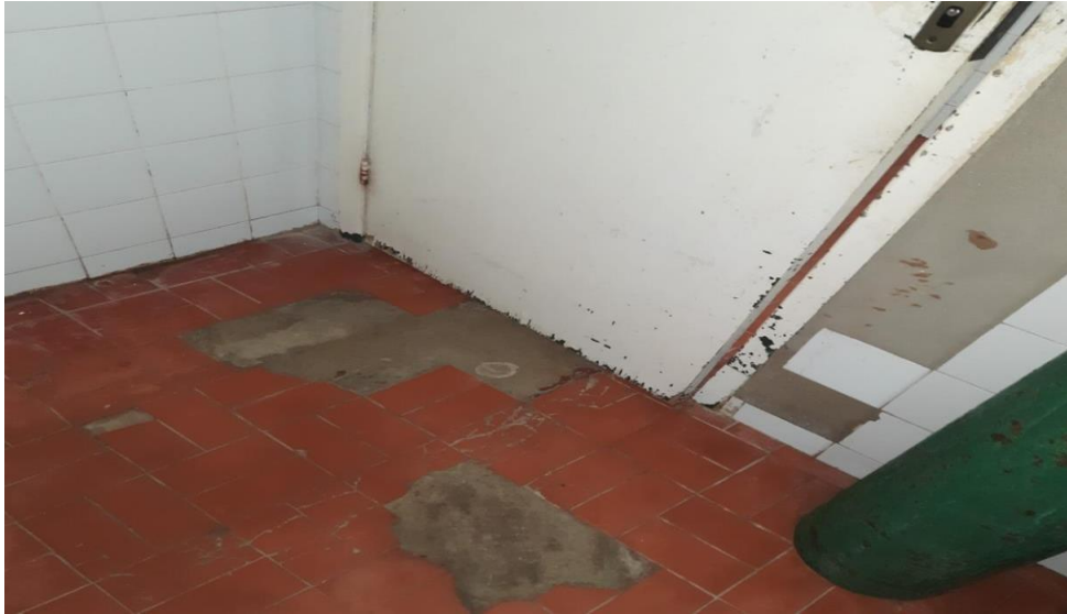
Figura 21 – Destacamento do piso.
