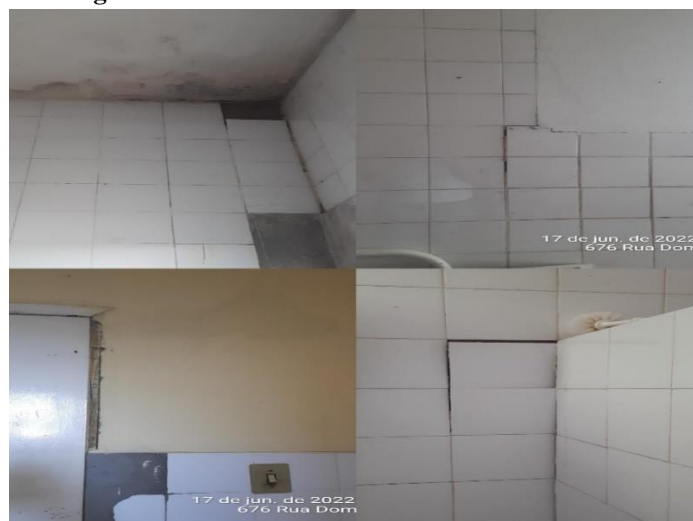
Figura 19 – Destacamento da cerâmica nos ambientes.
