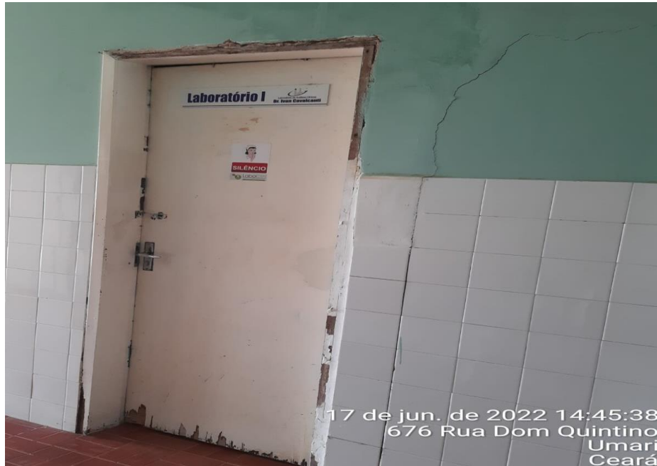
Figura 15 – Fissura vertical próximo a porta.
