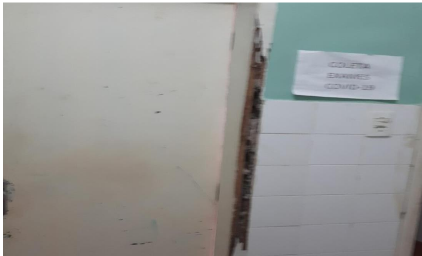
Figura 36 – Defeito nas esquadrias devido a pragas (cupins).
