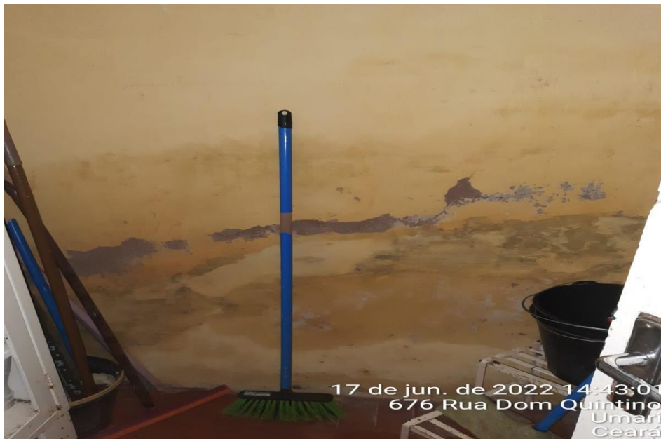
Figura 15 – Umidade ascendente na parte interna.
