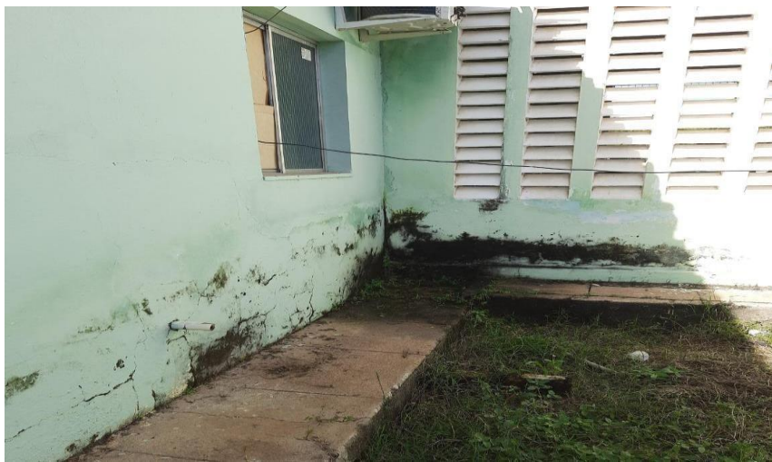
Figura 30 – Falhas na tubulação Hidrossanitária.
