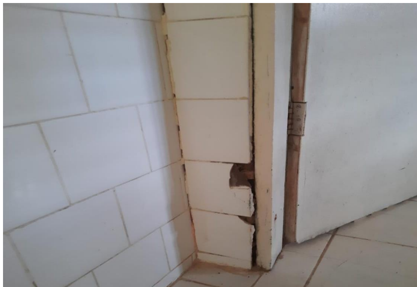
Figura 20 – Revestimento quebrando e destacado da parede.
