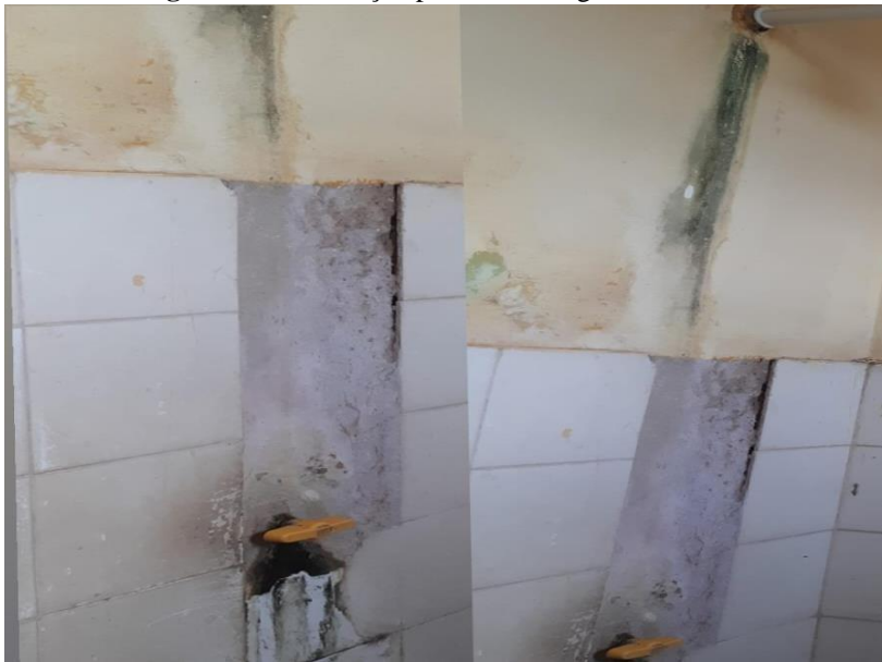
Figura 28 – Infiltração próximo ao registro do chuveiro.
