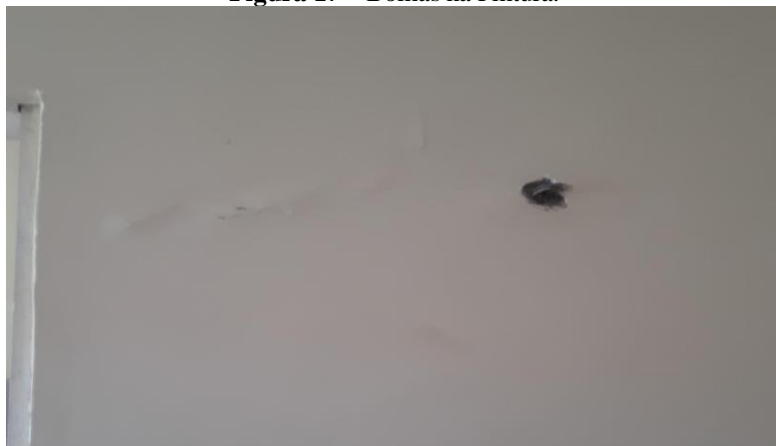
Figura 17 – Bolhas na Pintura.
