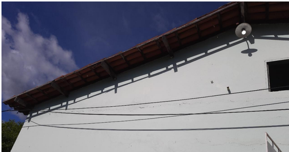
Figura 16 – Fissura horizontal próxima ao teto.
