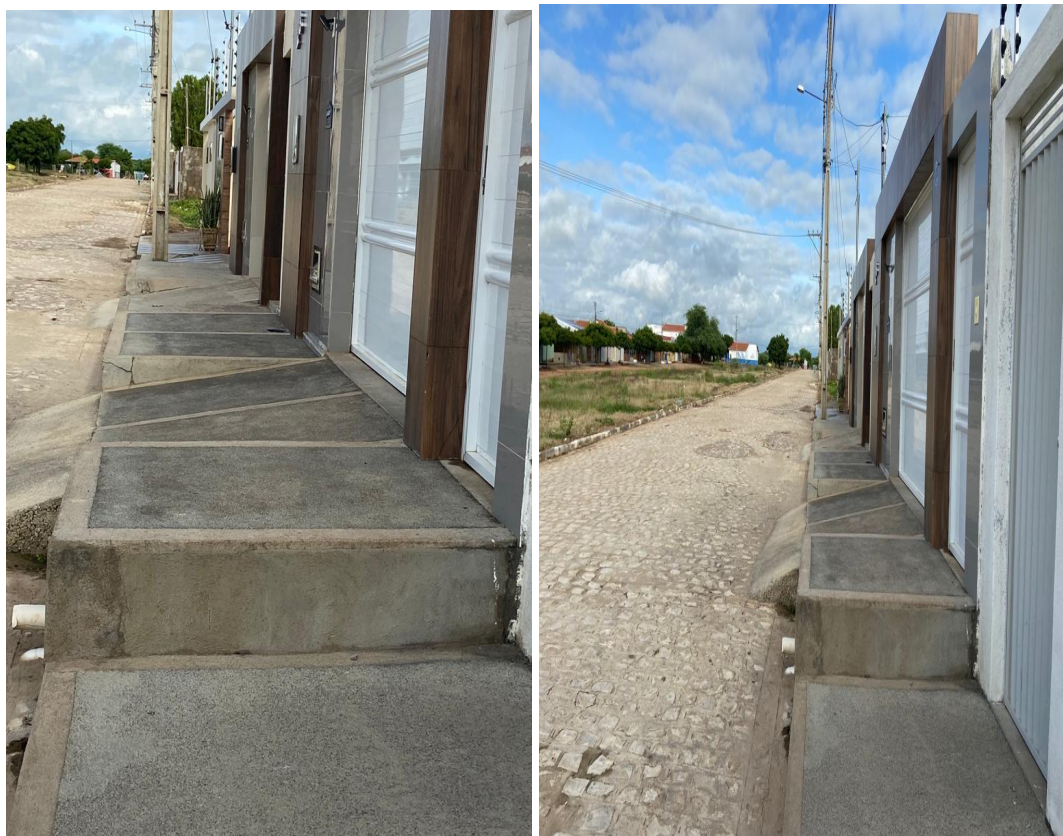
FIGURA 9 – EXEMPLO DE CALÇADAS COM DESNÍVEL E RAMPA MUITO INCLINADA NA CIDADE DE SÃO JOÃO DO RIO DO PEIXE-PB
