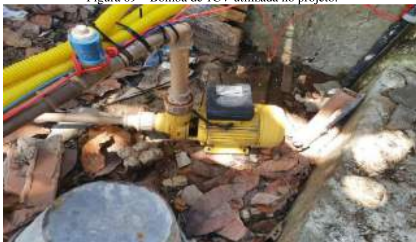
Figura 69 – Bomba de 1CV utilizada no projeto.
