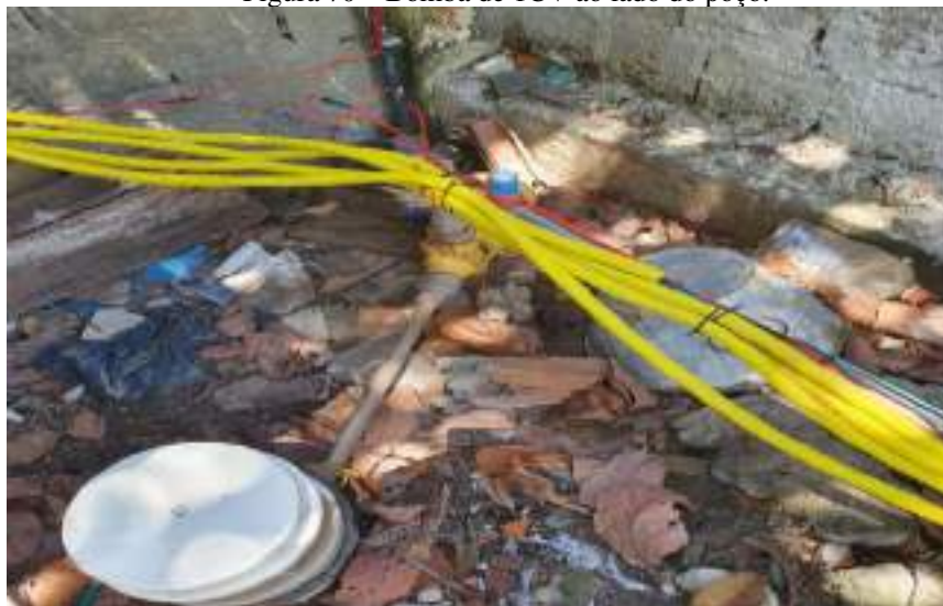
Figura 70 – Bomba de 1CV ao lado do poço.
