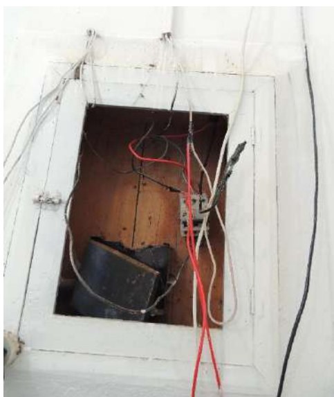
Figura 6 – Quadro de Energia Desprotegido Presente na Área da Recepção.
