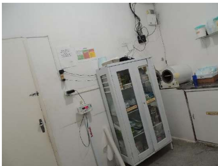
Figura 9 – Excesso de Fiação Elétrica Exposta e Sobrecarga de Tomadas na Sala de Triagem.
