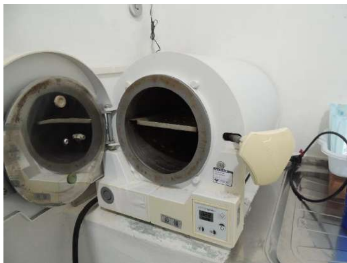
Figura 11 – Equipamento de Autoclave Instalada na Sala de Triagem.
