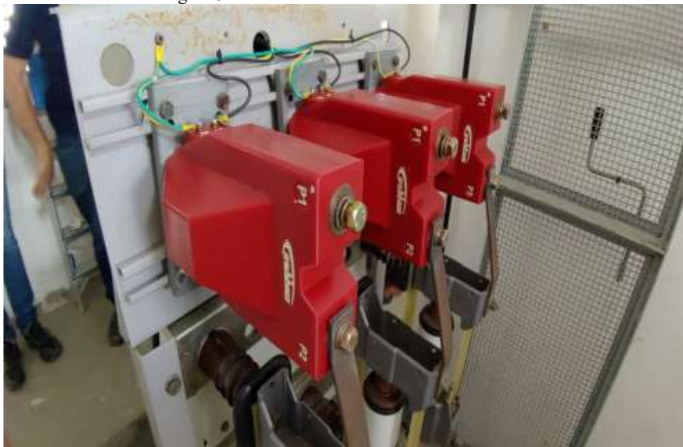
Figura 32 – Transformadores de Corrente Novos.
