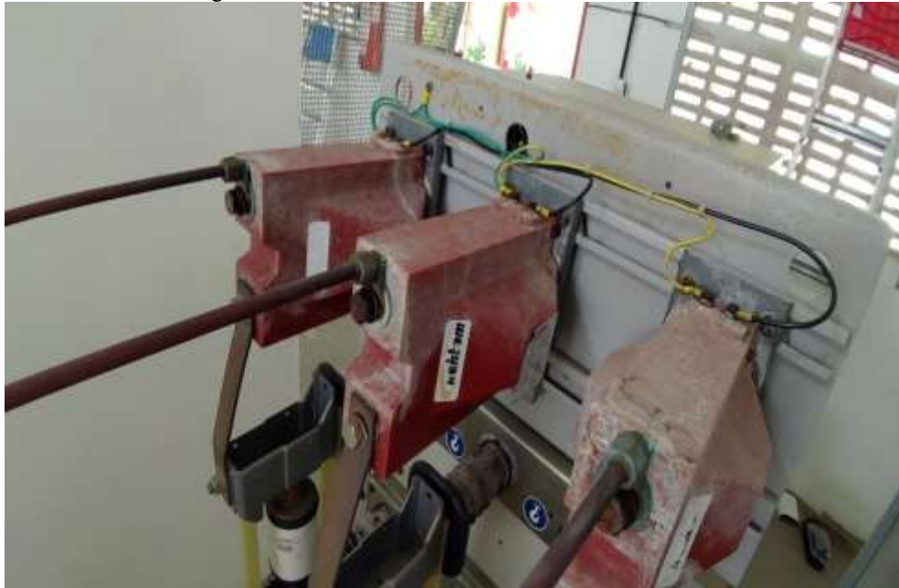
Figura 31 – Transformadores de Corrente Defeituosos.
