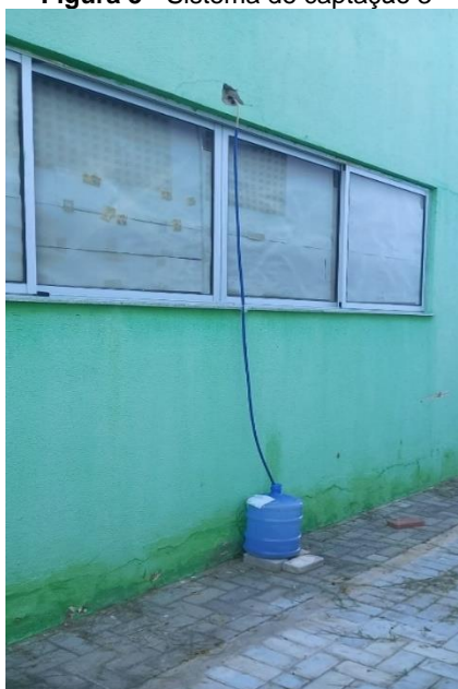
Figura 5 - Sistema de captação 3
