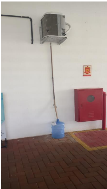
Figura 4- Sistema de captação 2
