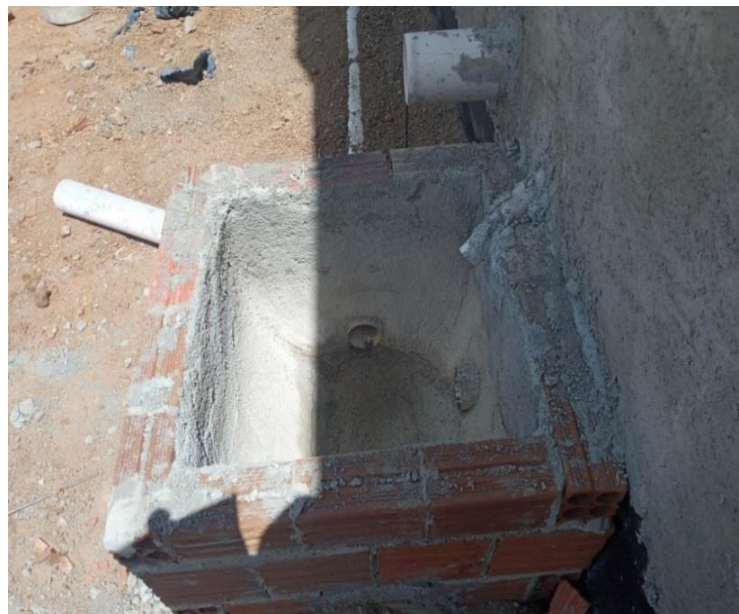
Figura 7 - Caixa de inspeção de esgoto
