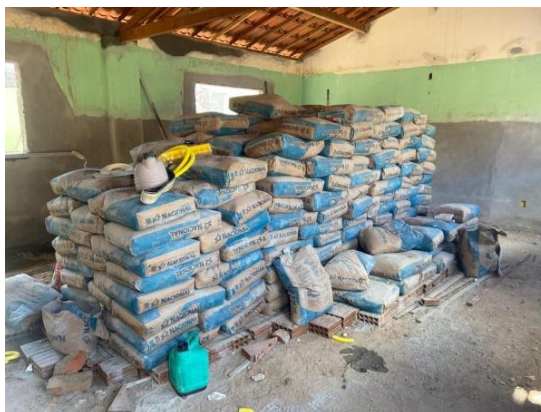
Figura 1 – Armazenagem do cimento
