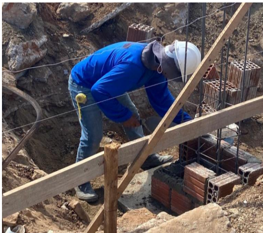
Figura 14 – Alvenaria em torno da ferragem
