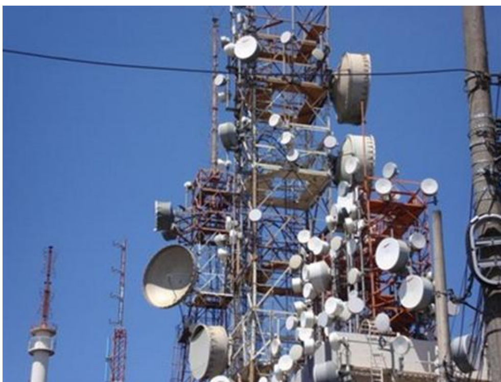
Figura 1-2 - Torre com antenas destinadas a múltiplos serviços [8].
