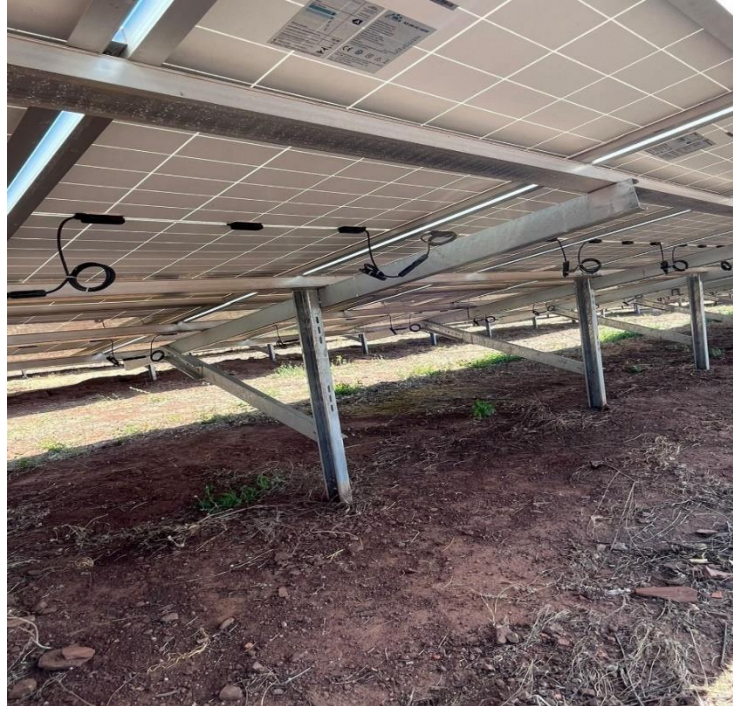
Figura 6 – Vista inferior de suporte físico para painel fotovoltaico.
