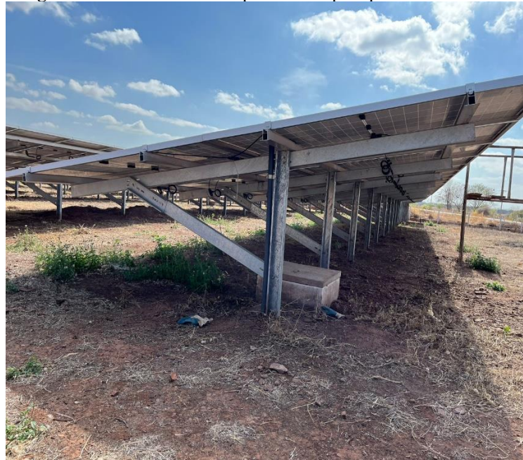
Figura 5 – Vista lateral de suporte físico para painel fotovoltaico.
