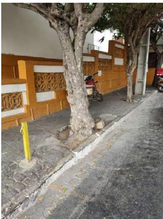
Figura 17 – Calçada Com Revestimento Irregular Fachada Sul
