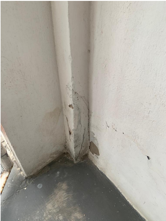
Figura 18 – P20 (Deslocamento, Trincas e Eflorescências)
