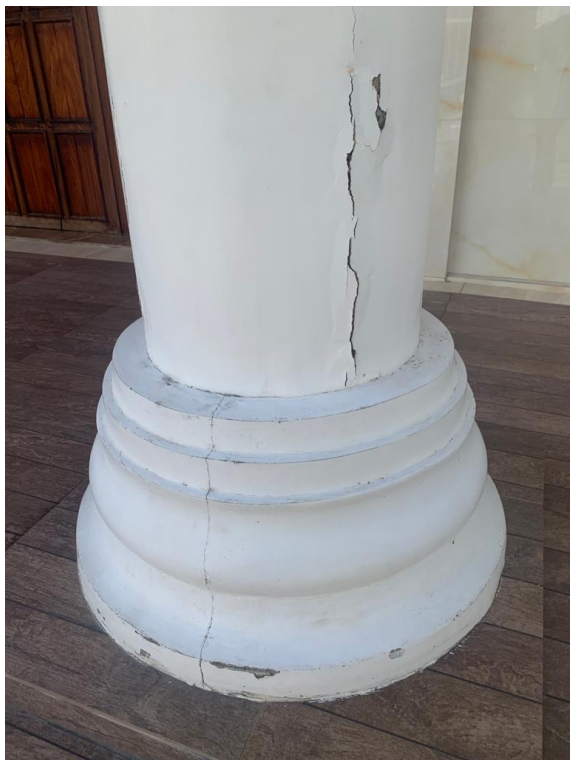
Figura 12 – P2 (Fissuras, Trinca e Desplacamento)
