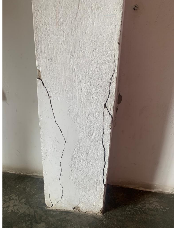
Figura 17 – P15 (Deslocamento e Trincas)
