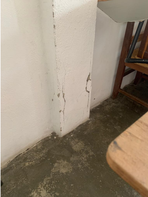
Figura 16 – P11 (Deslocamento e Trincas)
