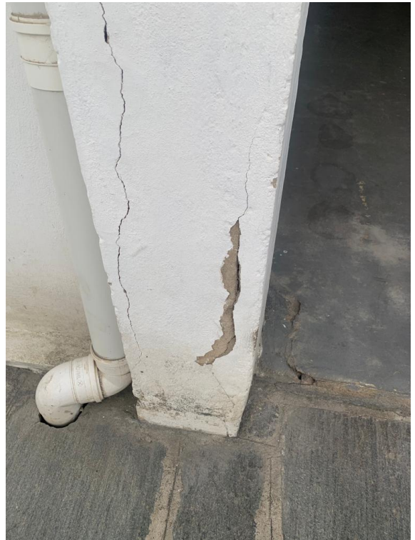
Figura 19 – P22 (Deslocamento, Fenda e Eflorescências)
