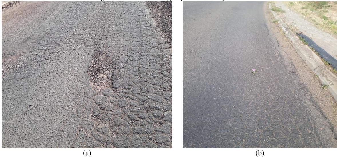
Figura 6- Trinca de fadiga tipo “Couro de jacaré”.
