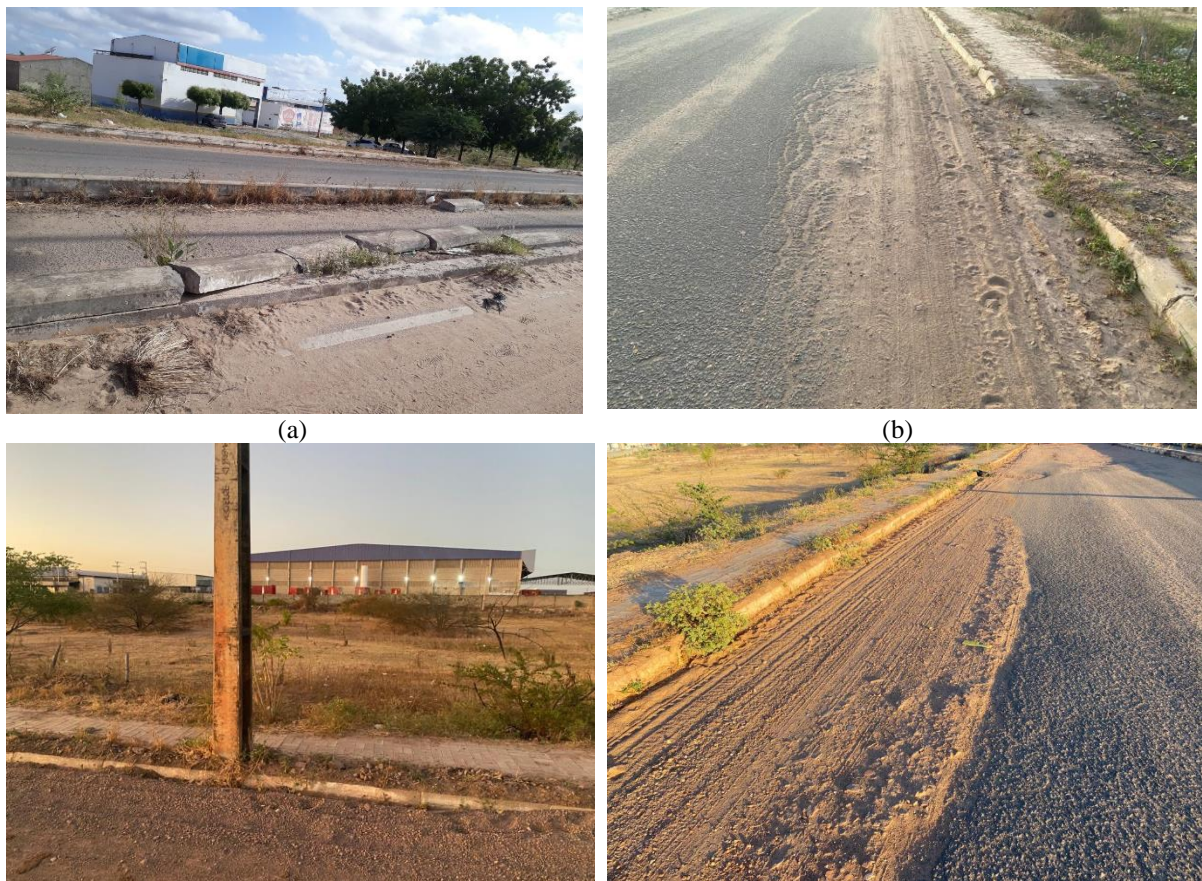
Figura 15-Falhas da conservação do passeio e via
