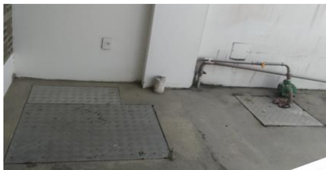
Figura 13: Parte externa do sistema para reutilização da água.
