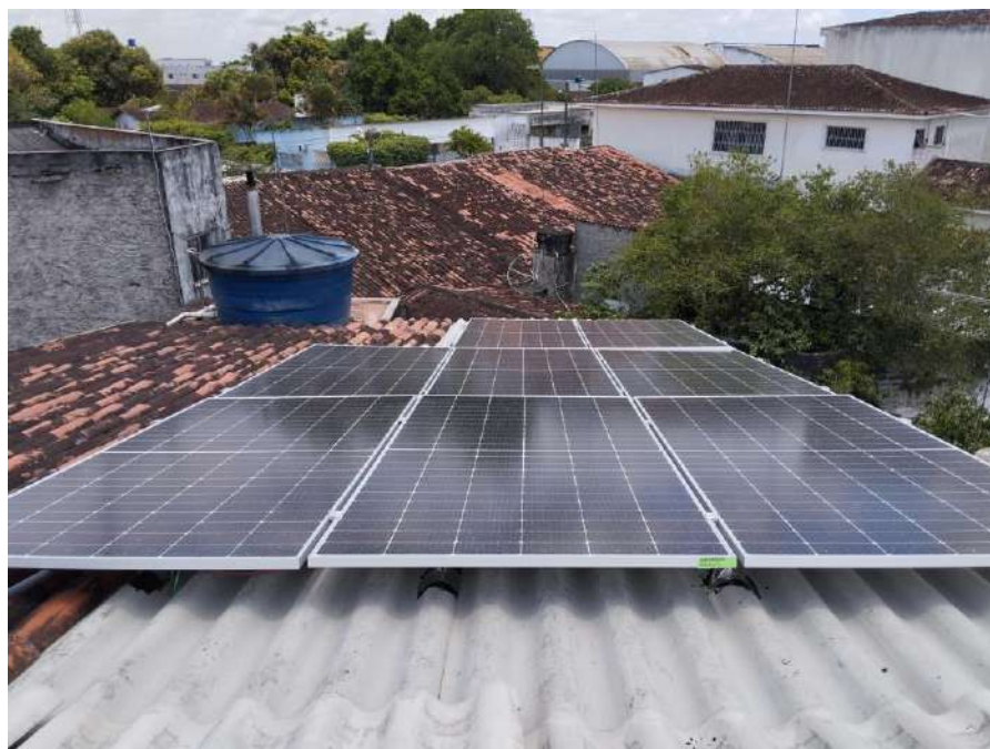
Figura 37 - Sistema Fotovoltaico instalado lado leste
