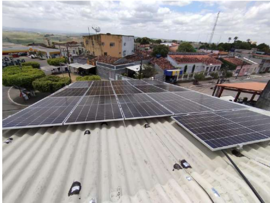
Figura 36 – Sistema Fotovoltaico instalado lado oeste
