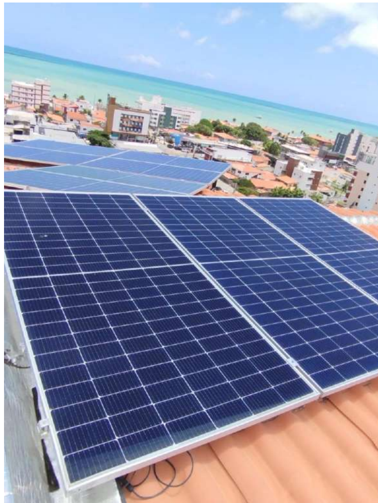
Figura 7 - Módulos fotovoltaicos instalados sobre o telhado
