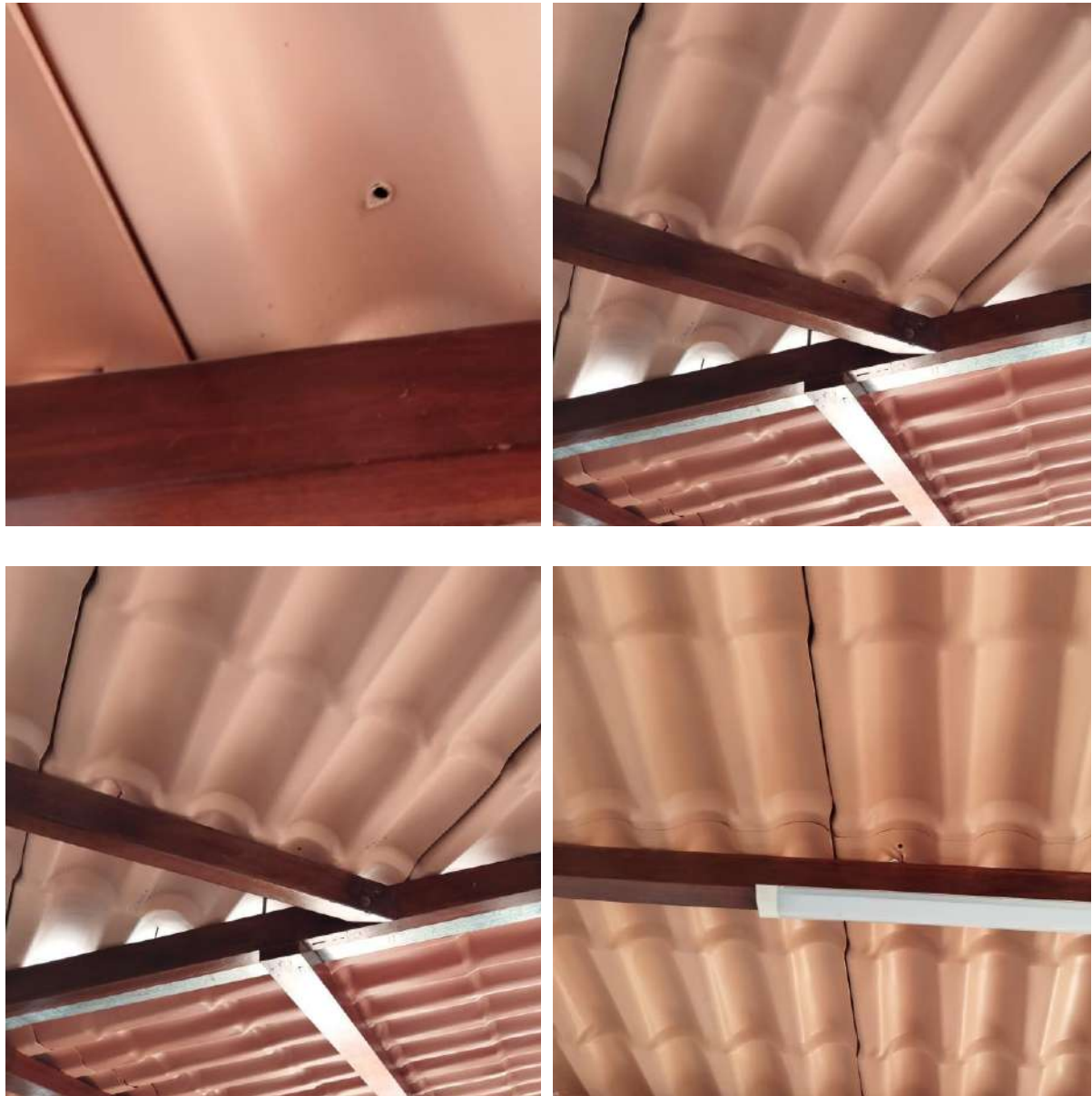
Figura 26 - Furos inadequados no telhado da instalação
