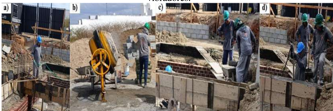
Figura 10: Concretagem das vigas: a) Molhagem das formas; b) Preparação do concreto na betoneira; c) Lançamento do concreto manualmente; d) Compactação do concreto utilizando vibradores.
