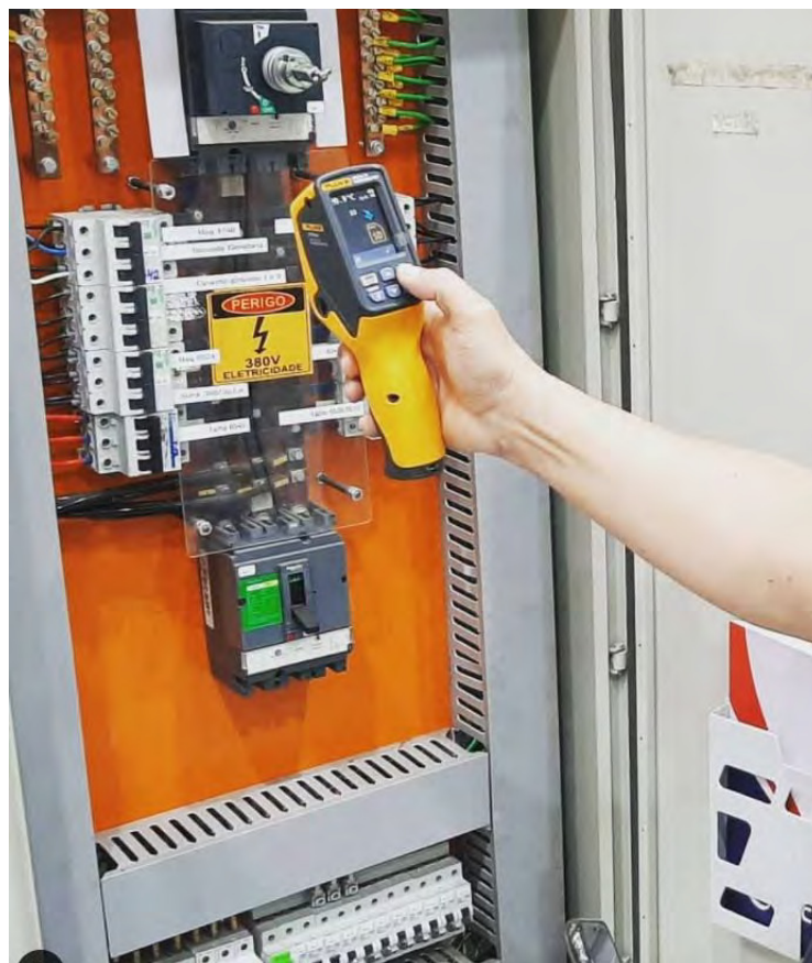
Figura 20 – Termografia em um painel de baixa tensão.
