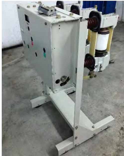
Figura 15 – Disjuntor de Média Tensão a Vácuo.
