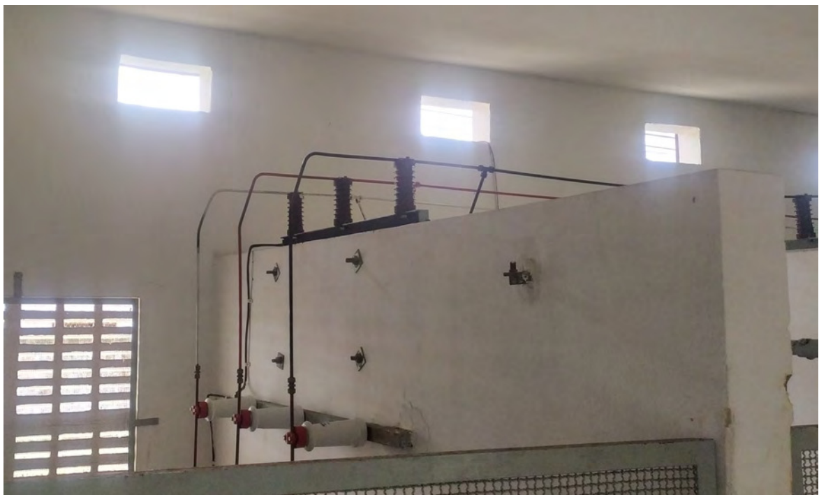
Figura 18 – Barramentos de média tensão e isoladores tipo pedestal.
