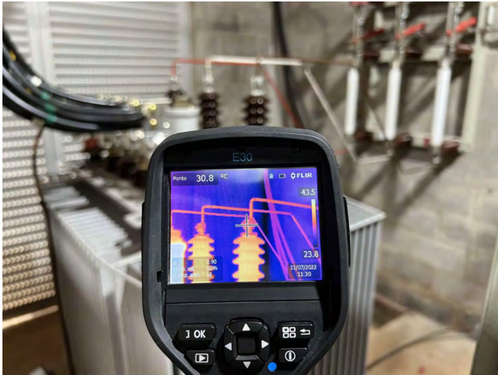
Figura 6 – Termografia em transformador de potência.
