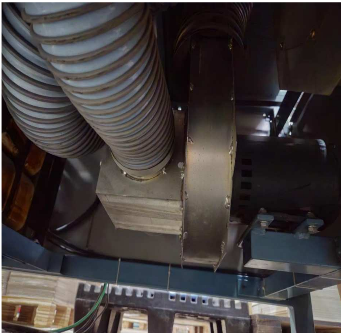
Figura 25 - Motor de exaustão
