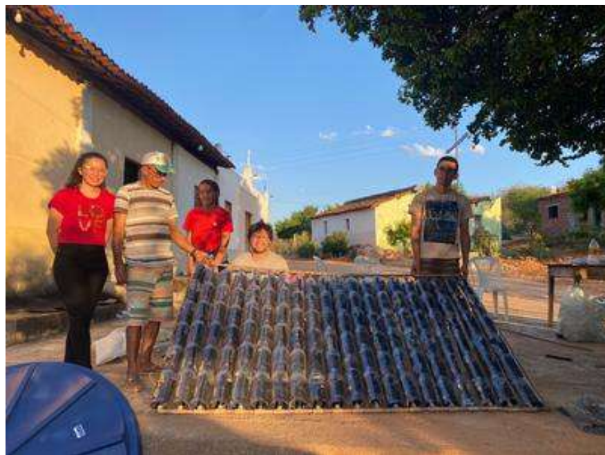
Figura 6 - Aquecedor solar sustentável finalizado.
