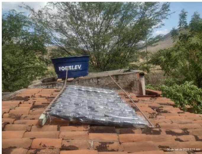
Figura 7 - Aquecedor solar acoplado a caixa d'água e instalado na casa escolhida.
